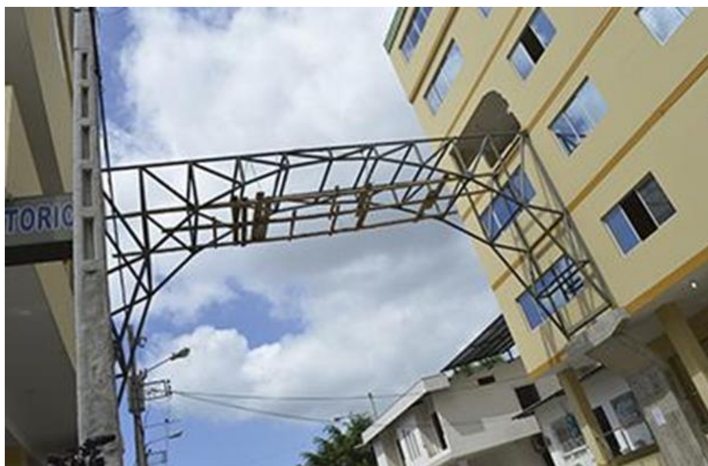
Ilustración 10. Clínica San Margarita después del sismo 16 Abril. (Fuente: El Diario)
