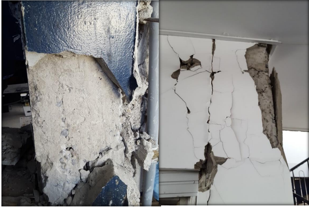
Ilustración 51 Daños no estructurales nudos y columna del edificio.
