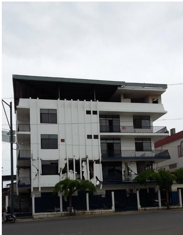
Ilustración 27. Edificio Senagua después del sismo de 16 de abril de 2016.
