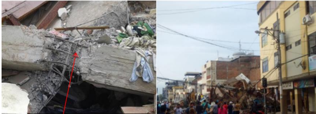
Ilustración 17. Edificio Pillín después del sismo. (Fuente: Ing. Roberto Aguiar y Ing. Jordy Mieles)
