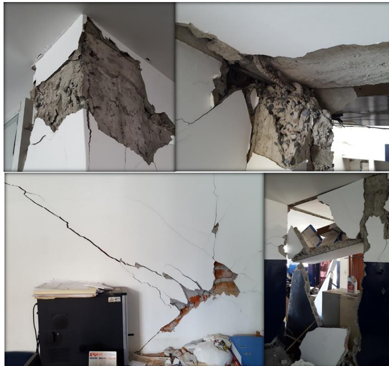
Ilustración 52 Daños no estructurales en el edificio de Senagua.
