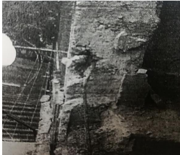
Ilustración 44 Elementos estructurales presentaron daños no estructurales
