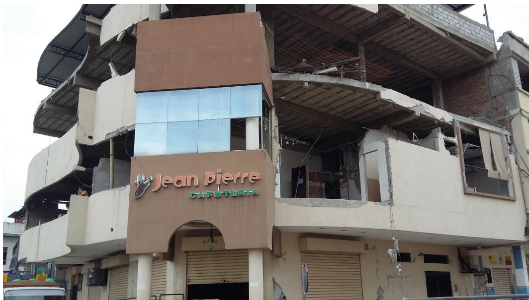
Ilustración 11. Edificio de la Cafetería Jean Pierre después del terremoto. (Fuente: Ing. Alex Villacrés)
