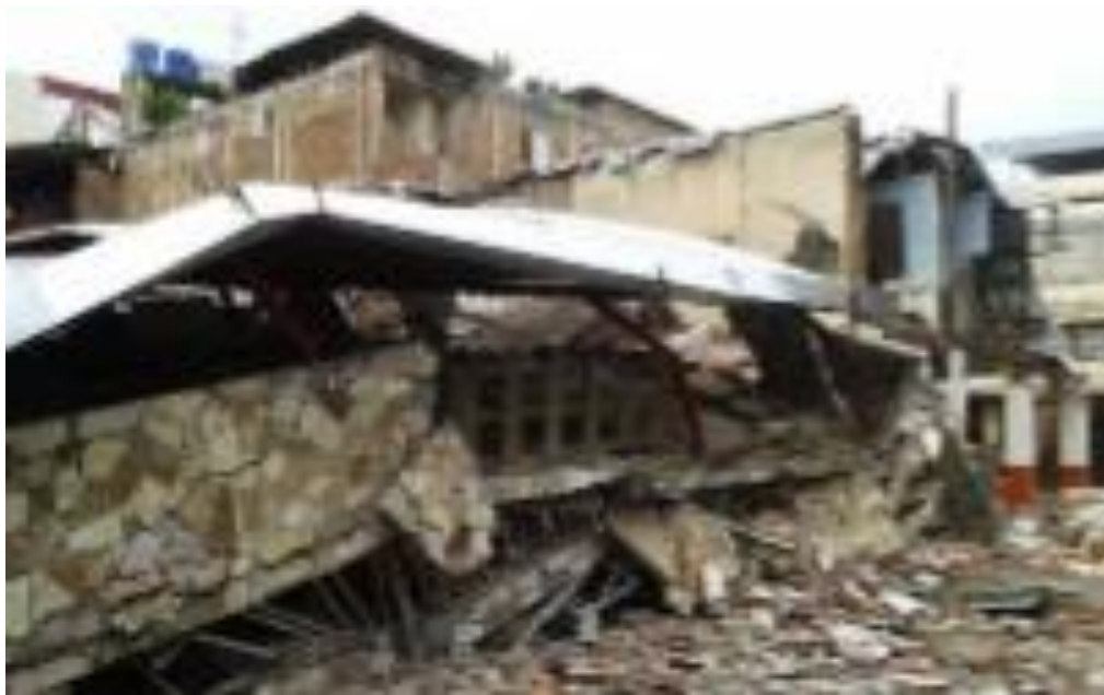
Ilustración 22. Almacén de Repuesto. (Fuente: Ing. Roberto Aguiar y Ing.Jordy Mieles)
