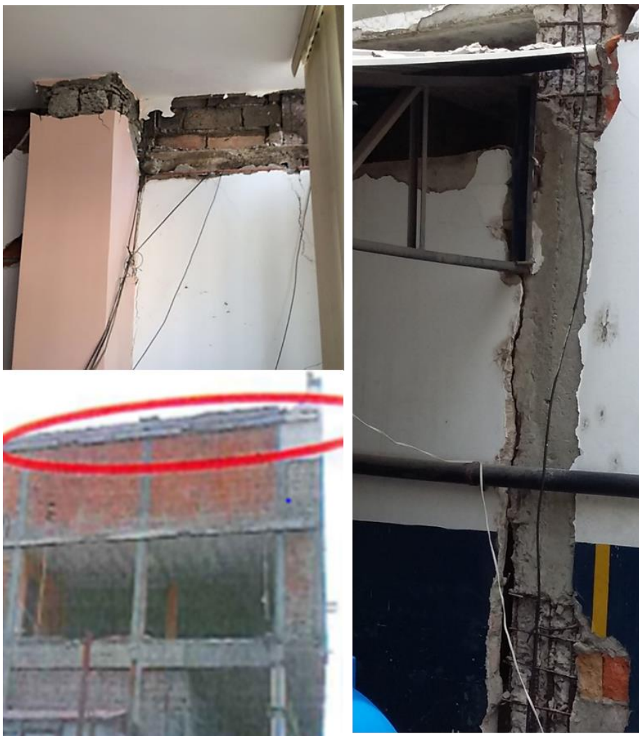
Ilustración 49 Daños no estructurales en la Jefatura de Cuerpos de Bomberos en Portoviejo.
