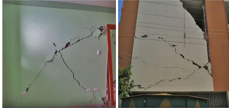
Figura 23. Estado de Daño tipo 3 en mampostería después del sismo en Ecuador 2016 (CHIOZZI A. Y MIRANDA E., 2017)
