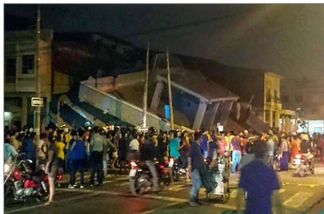
Figura 2. Edificio de la esquina Ayacucho y García Moreno en Guayaquil, después del evento de 16 de abril de 2016 (RADIO MORENA, 2016)
