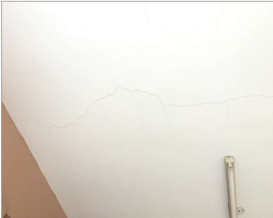
Fisuras en el tumbado en el Segundo Piso
