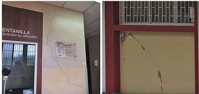
Figura 21. Estado de Daño tipo 2 en mampostería después del sismo en Ecuador 2016 (CHIOZZI A. Y MIRANDA E., 2017)
