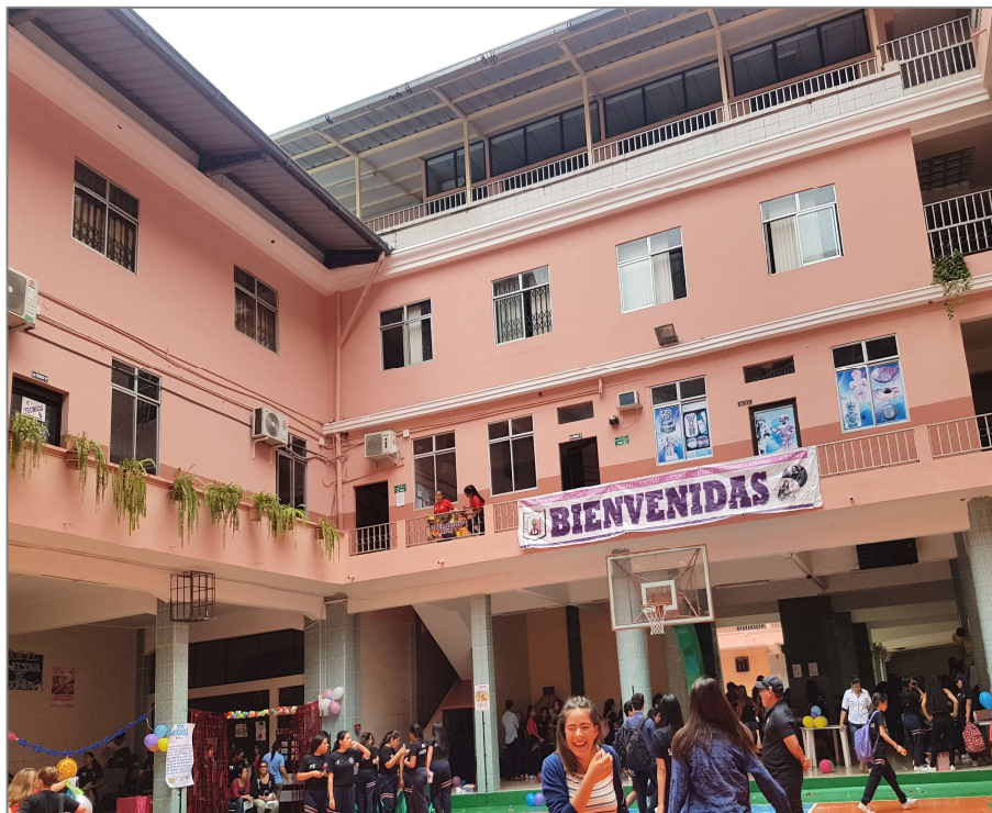
Retroceso excesivos en las esquinas – Irregularidad en Planta
