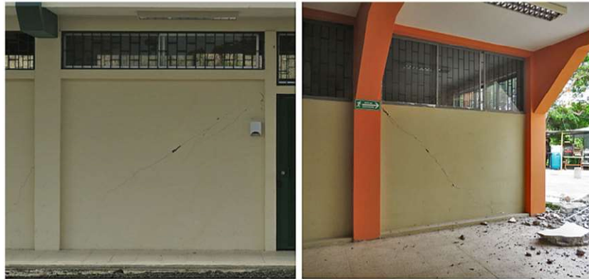
Figura 19. Estado de Daño tipo 1 en mampostería después del sismo en Ecuador 2016 (CHIOZZI A. Y MIRANDA E., 2017)
