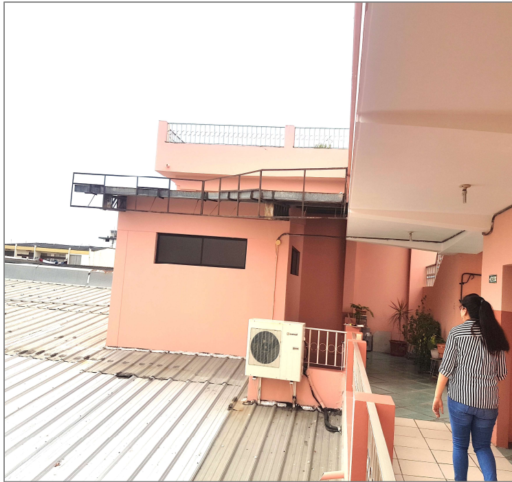
Irregularidad geométrica en Cuarto Piso – Irregularidad en Elevación
