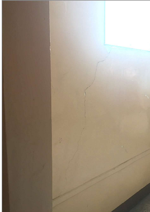
Fisuras en la antepecho en Segundo Piso
