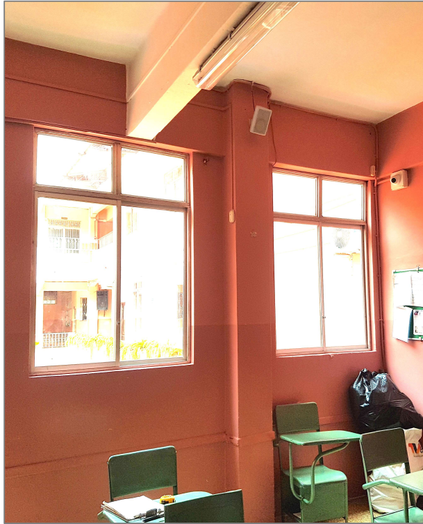
Columnas Cortas en Primer Piso Irregularidad en Elevación
