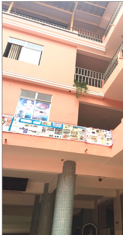
Irregularidad geométrica de retroceso en pisos superiores en Ala Este - Irregularidad en Elevación
