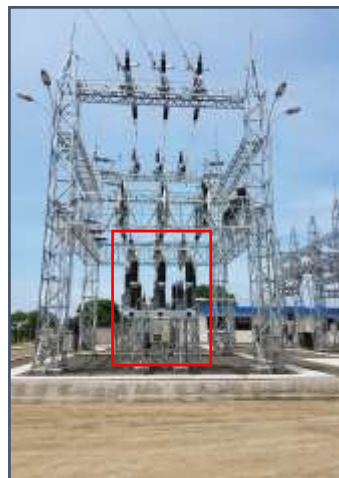
Figura 2.8: Interruptor de potencia SF6 en sitio Elaborado por: Autor
