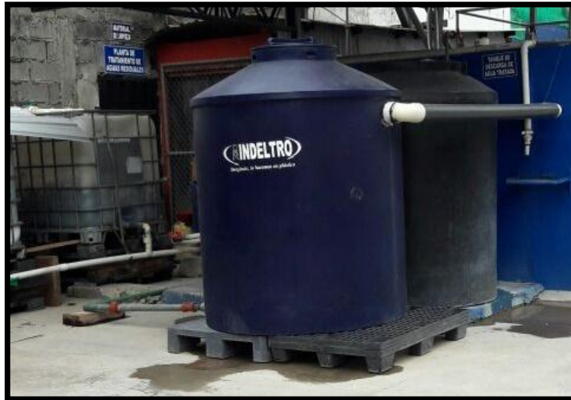
Figura 14. Tanques de agua. Fuente: El autor
