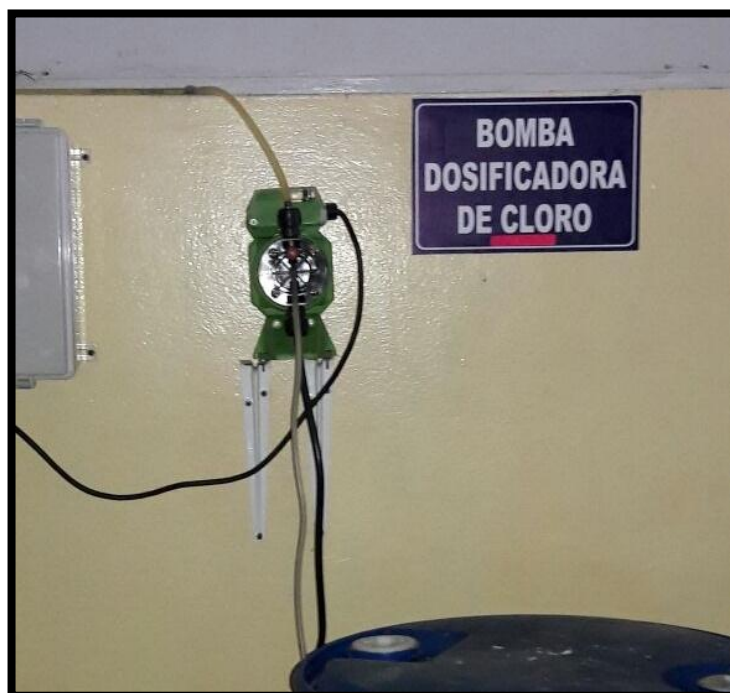
Figura 11. Bomba dosificadora de cloro. Fuente: El autor
