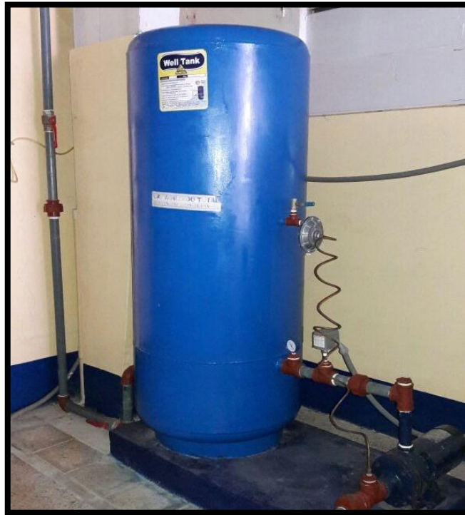
Figura 12. Tanque de presión. Fuente: El autor
