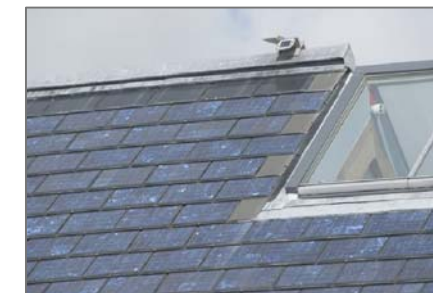
Cubierta de paneles solares
