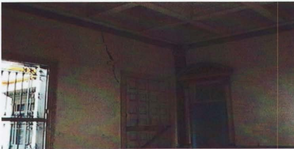
Foto 28. Grieta diagonal en esquina superior del vano. Casa republicana en Chorrillos, Lima. Foto D. Torrealva.
