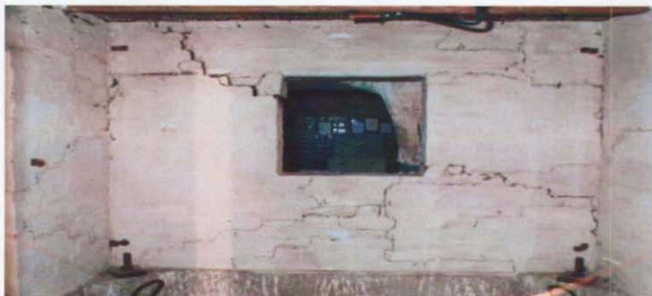
Foto 31. Grietas diagonales en esquina del vano, reproducidas en ensayo dinámico en mesa vibradora. Módulo con techo. Foto: LEDI
