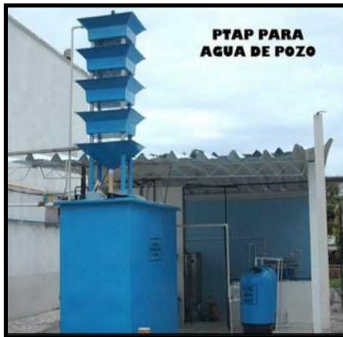
Ilustración 5 - Planta de tratamiento para agua de pozo
