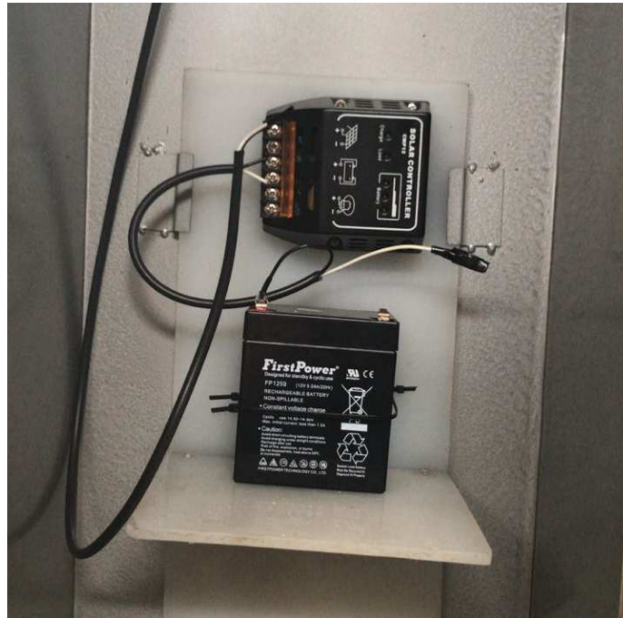
Figura 29. Batería y controlador panel solar. Fuente: Elaboración propia.
