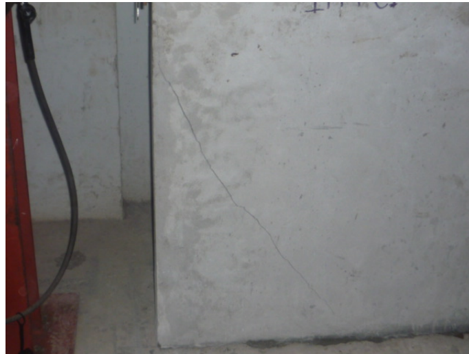
- 13. Fallas en pared sin fibra -
