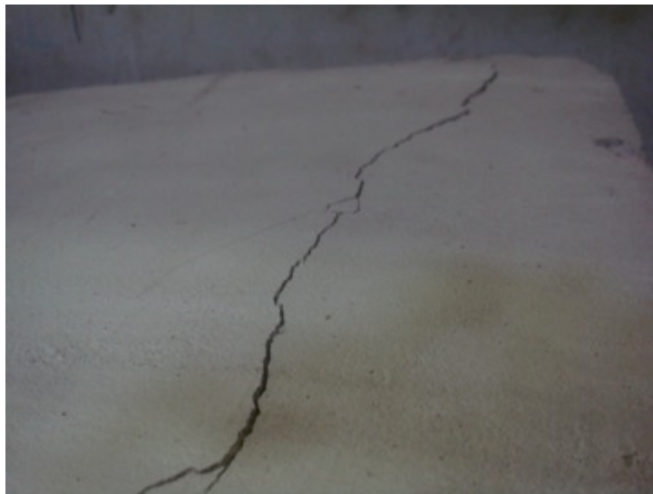
Ilustración 42: Fisura al borde del panel sobre la viga de apoyo
