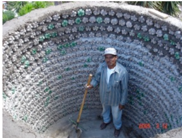
Ilustración 5: Tanque de agua de Ecotec
