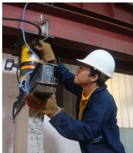
Ilustración 45: Revisión de mangueras del sistema hidráulico
