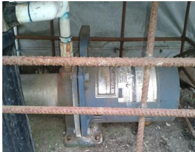
Figura 4. 3 Bomba del proceso lavado
