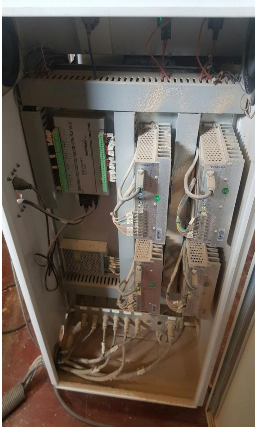
Foto 4.3: Gabinete del Router Fuente: (El Autor, 2019)
