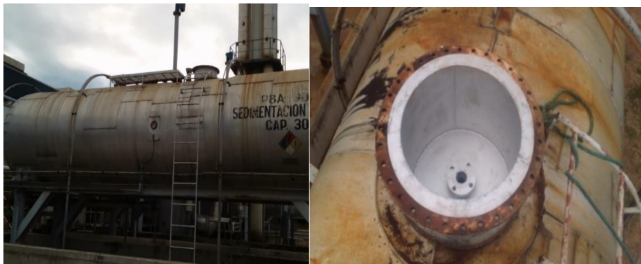
Figura 25: Instalación de base del sensor. Fuente: Autor
