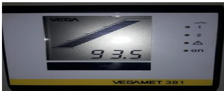
Figura 42: Controlador Vegamet 381 indicando su nivel alto. Fuente: Autor
