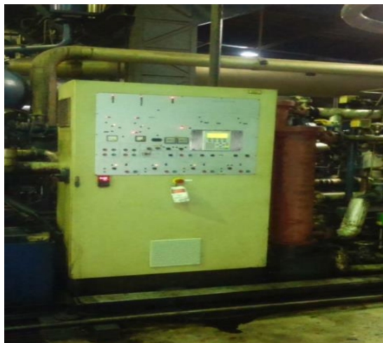
Figura 35: Vista frontal del tablero energizado.
