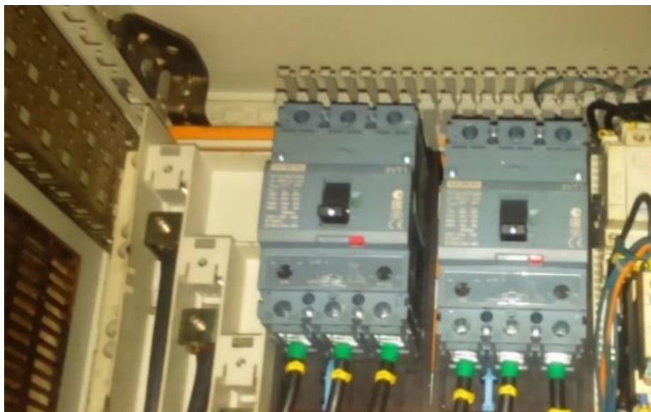
Figura 32: Disyuntores instalados. Fuente: Autor
