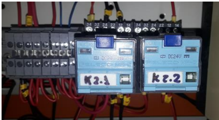
Figura 28: Instalación de relé de 24 vdc. Fuente: Autor
