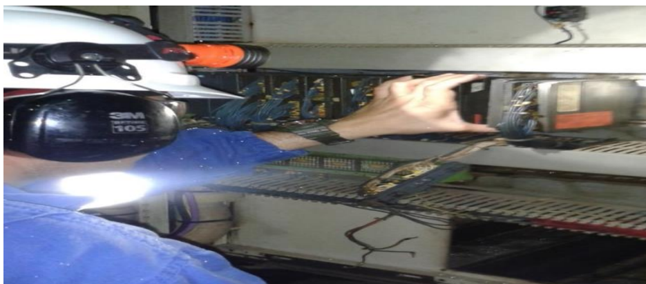
Figura 34: Montaje de modulo analógico. Fuente: Autor
