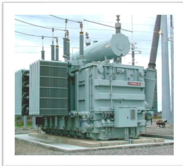
Figura 2.3. Transformador de gran potencia Fuente: Dobladez (2005)
