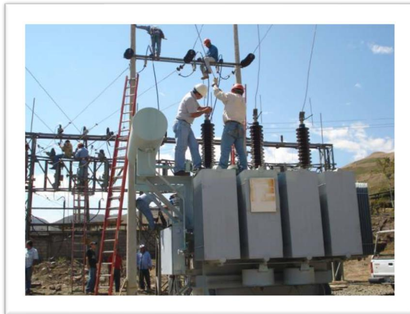
Figura 2.6. Transformador de gran potencia Fuente: Subestación El Pache (2010)
