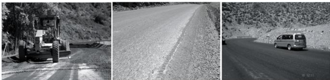
Ilustración 8 Camino industrial División Andina, Codelco Chile. Carpeta estabilizada con Cloruro de Sodio
