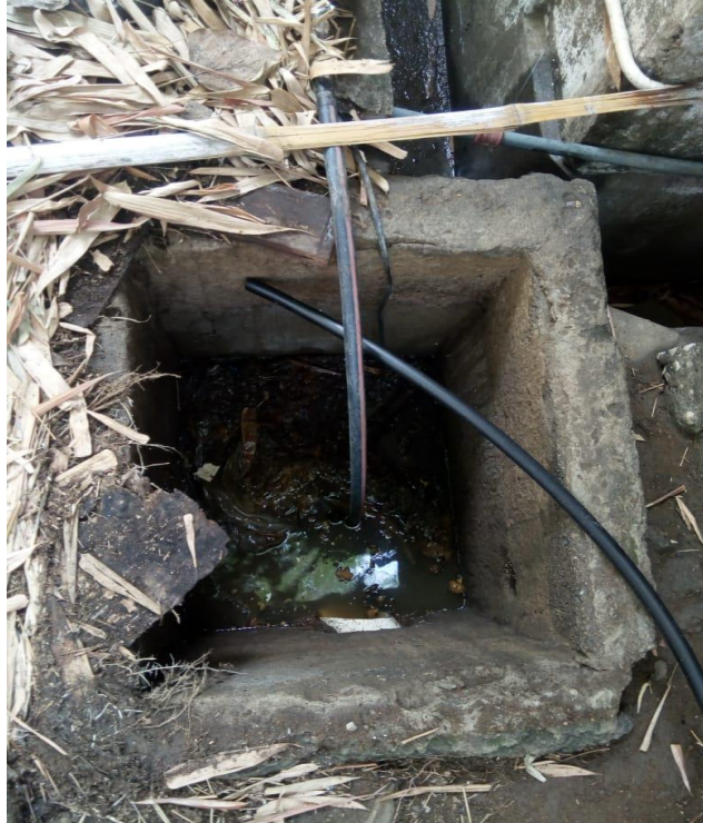
Ilustración 11 Caja de revisión, aguas residuales
