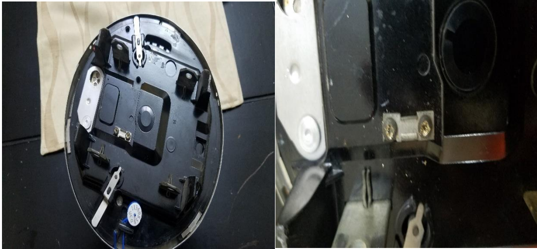
Ilustración 21. Medidor con puente potencial flojo. Fuente: Autor.
