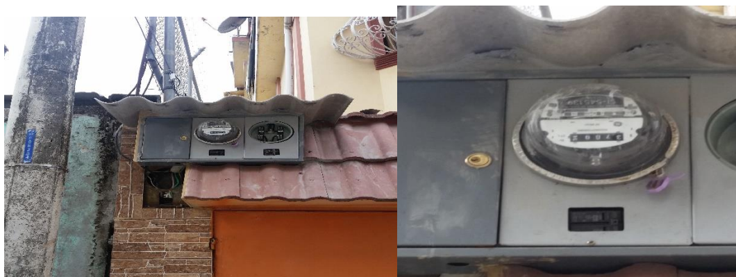
Ilustración 22. Medidor virado. Fuente: Autor.
