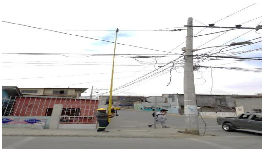
Figura 13. Parroquia Anconcito. Línea monofásica con sobrecarga
