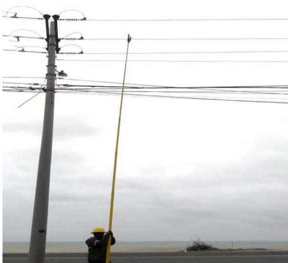
Figura 11. Método de medición con vatímetro, utilizando la pértiga
