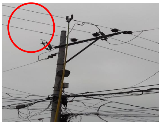
Figura 10. Fotografía mediciones realizadas en trifásico Troncal
