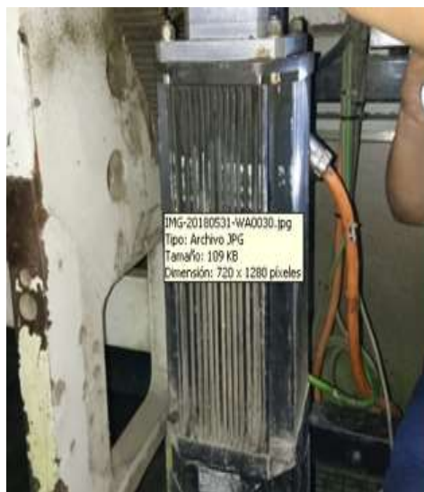
Figura 4. 12 Motor Transferencia en vacío introductor IMP 1
