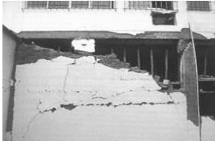
Ilustración 3. Falla del primer piso de una estructura con PRM, Papoyán, 1983. Fuente: (Revista Noticreto No. 36, 1995)
