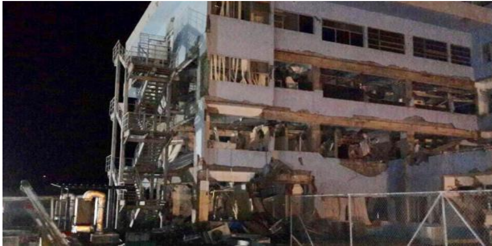
Ilustración 6. Instalaciones del hospital del IESS de Manta tras el terremoto. Fuente: (Diario EL COMERCIO; Andrés Jaramillo, 2016)
