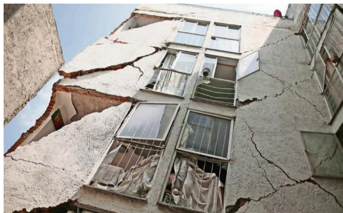
Ilustración 4. Daños tras terremotos de México 19 de septiembre de 2017. Fuente: (José Pablo Espíndola, 2017)
