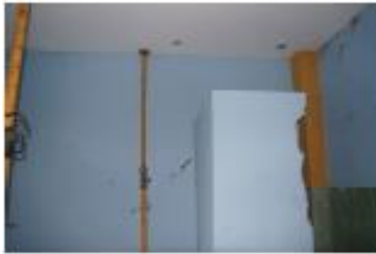
Figura 35. Daño severo en mampostería.
