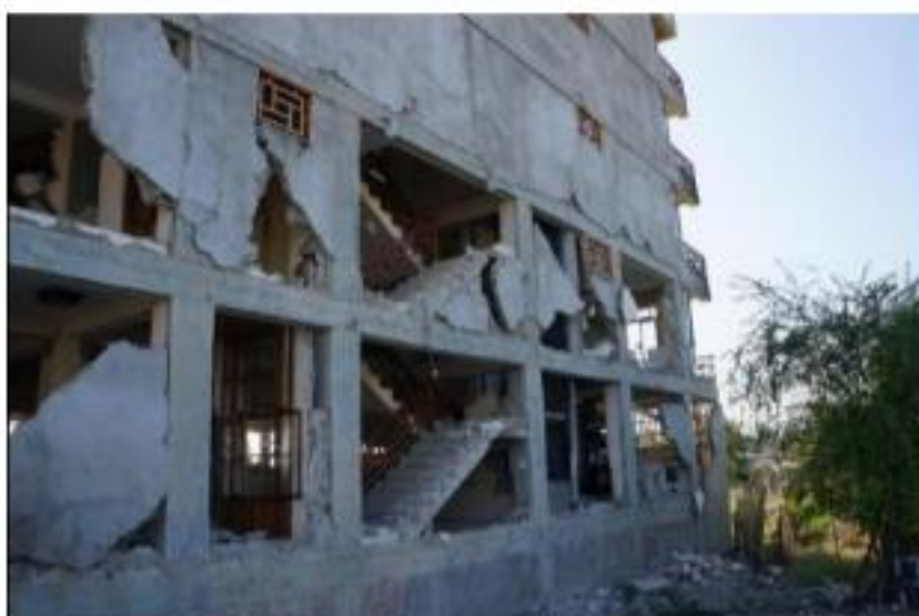
Figura 30. Edificio luego del terremoto del 16 de abril del 2016.
