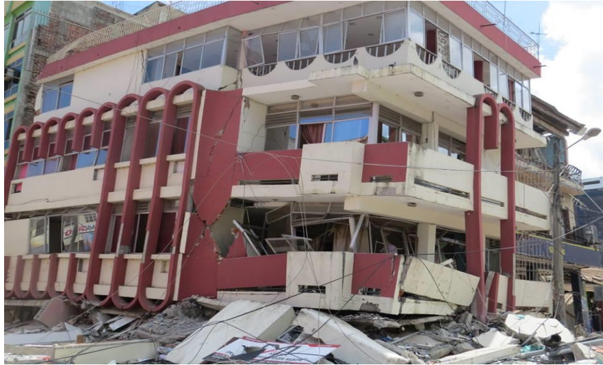
Figura 27. Edificio después del terremoto del 16 de abril del 2016.
