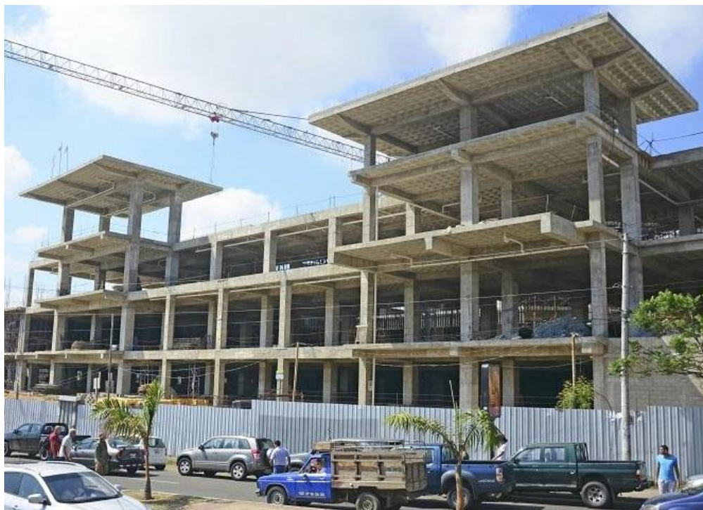
Figura 23. Edificio en construcción después del terremoto. Foto obtenida del Ing. Alex Villacrés.
