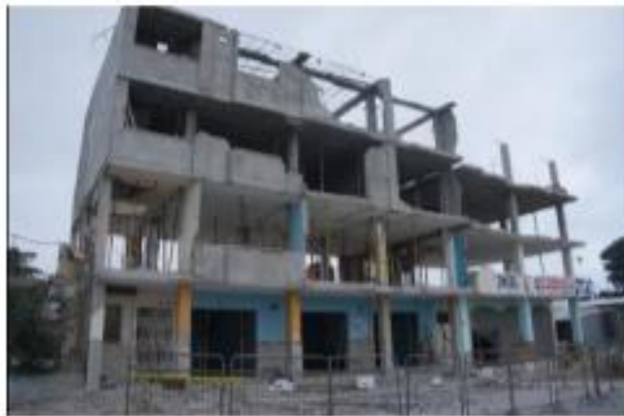
Figura 34. Estructura después del terremoto del 16 de abril del 2016.
