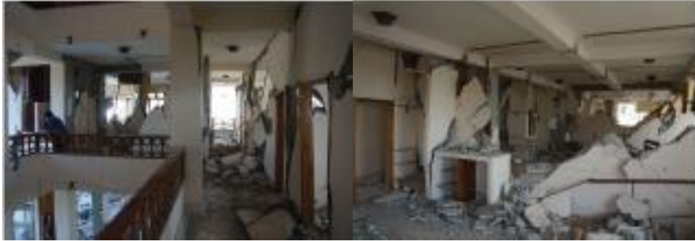
Figura 31. Colapsos de paredes de mampostería.
