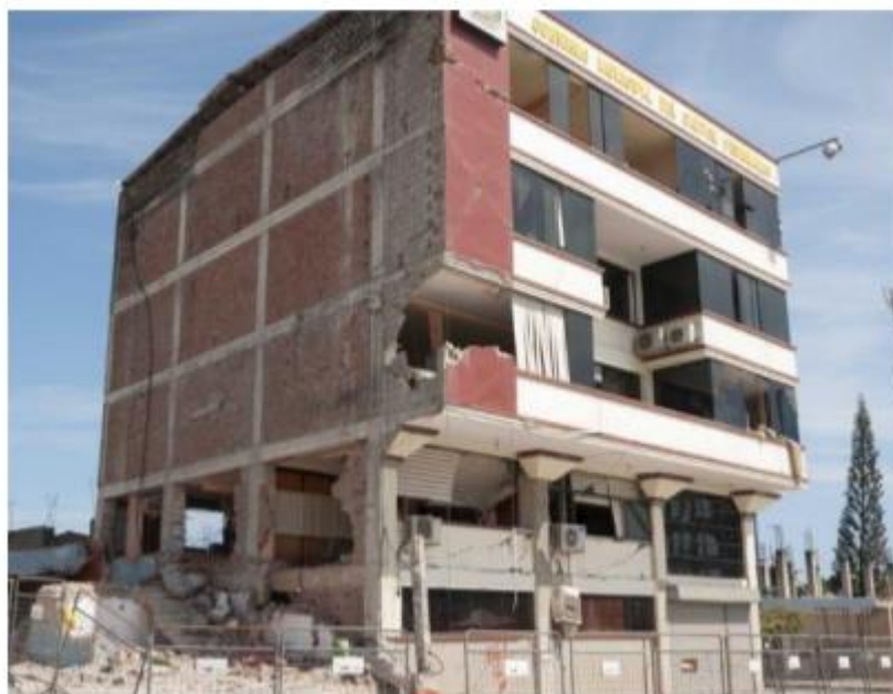
Figura 15. Foto del edificio después del terremoto.
