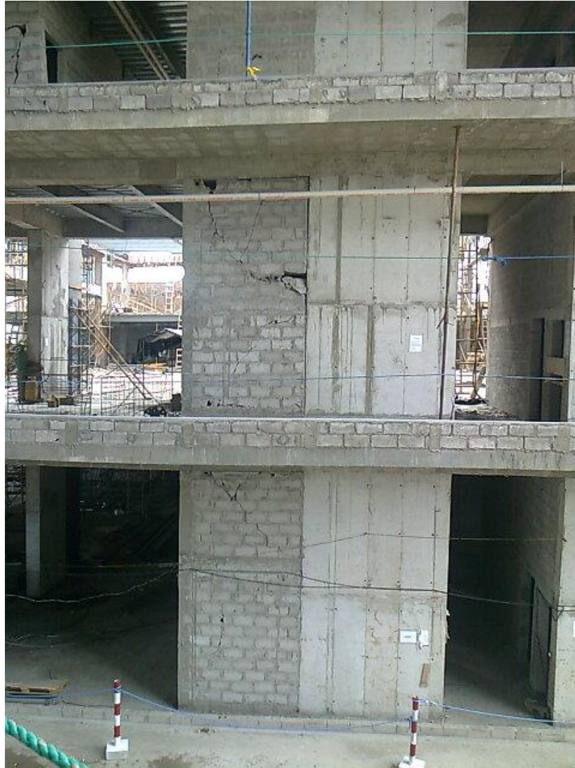
Figura 55. Daños em paredes de mampostería. Foto obtenida del Ing. Alex Villacrés.
