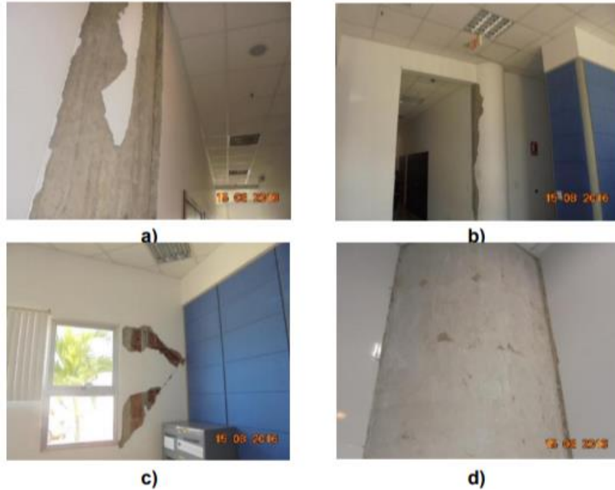
Figura 18. a) Caída de enlucido en columnas circulares; b) Enlucido muy grueso; c) Fisuras en recubrimiento de columna; d) Daño en Mampostería.
