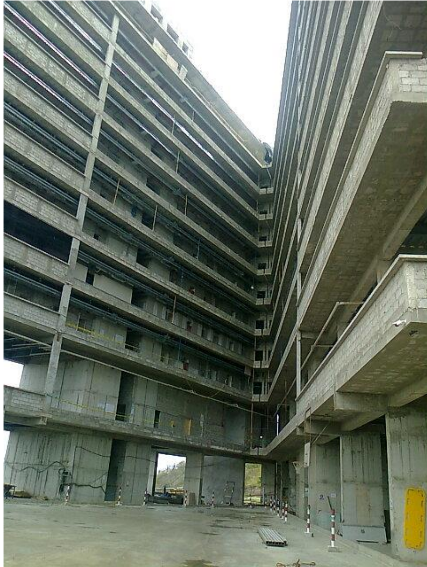
Figura 54. Hotel Sail plaza en construcción, después del sismo del 2016. Obtenida del Ing. Alex Villacrés.
