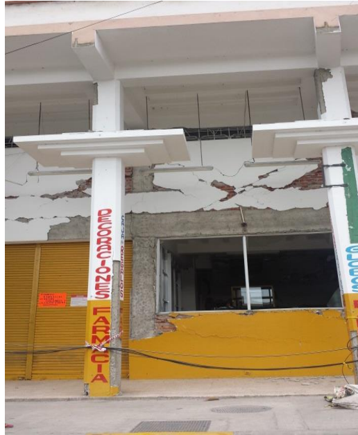
Figura 13. Edificio después del terremoto del 16 de abril del 2016.
