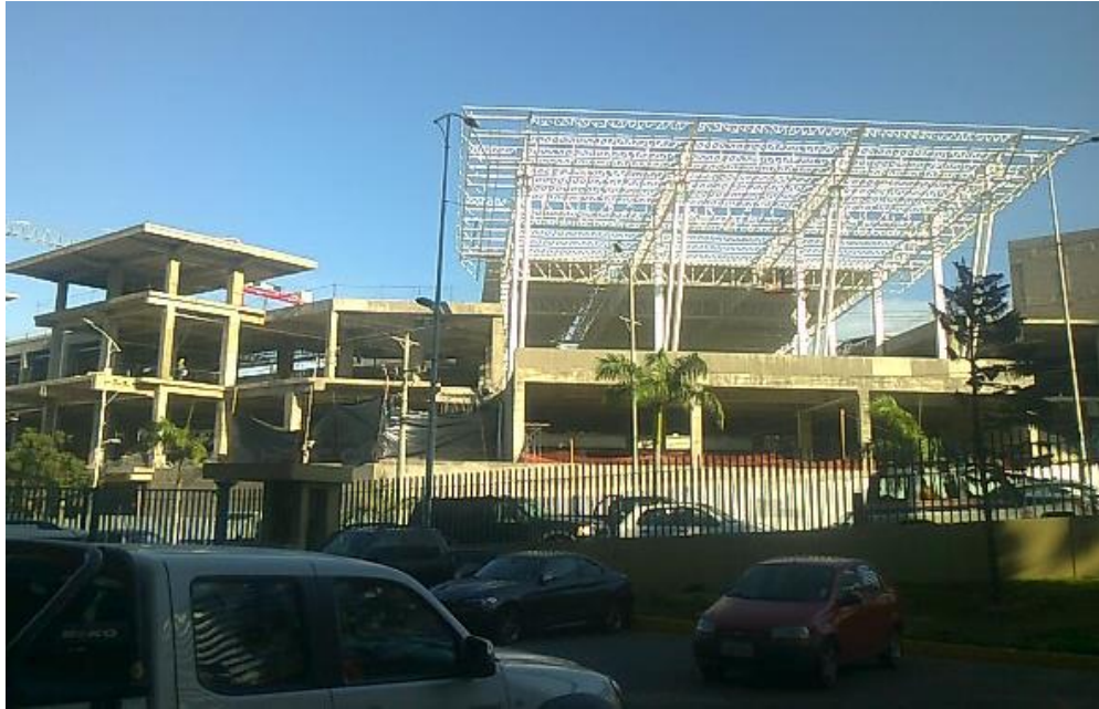
Figura 22. Edificio en construcción después del terremoto. Foto obtenida del Ing. Alex Villacrés.
