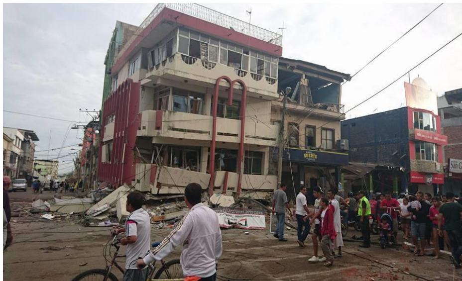
Figura 26. Edificio después del terremoto del 16 de abril del 2016.
