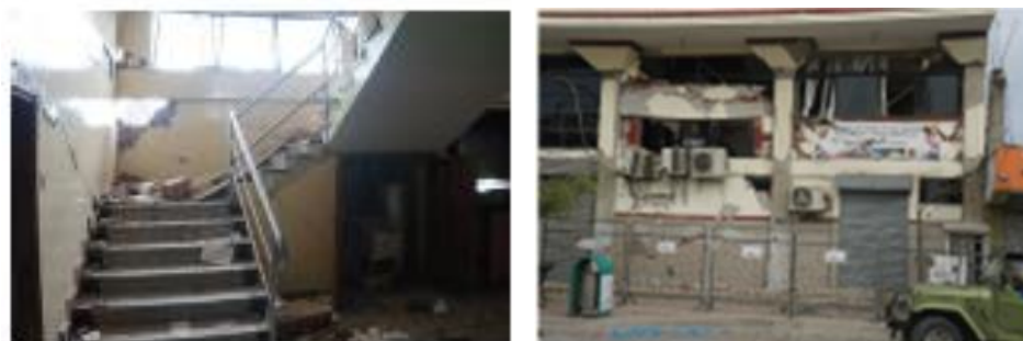
Figura 16. Fotos de la estructura tomada después del terremoto del 2016.
