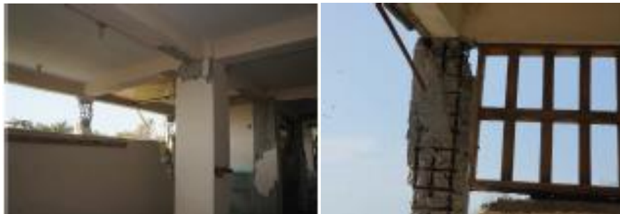
Figura 32. Fallos en columnas.
