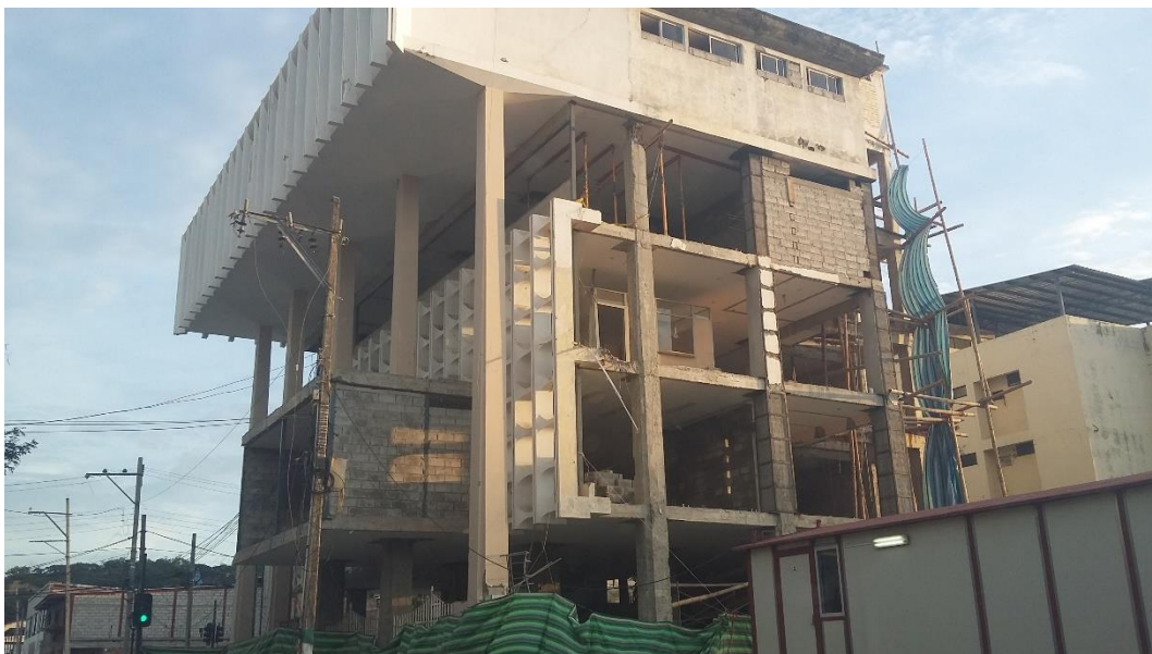
Figura 39. Estructura después del terremoto del 16 de abril del 2016. Obtenida por el Ing. Alex Villacrés.
