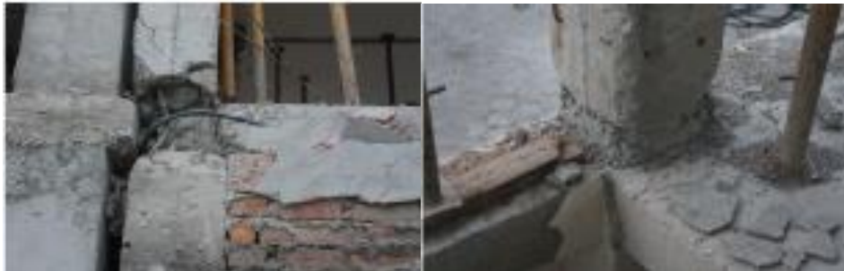
Figura 36. Fallos en columnas.
