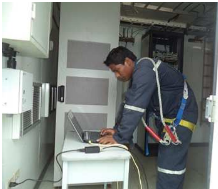
Figura # 4. 27 Configuración de equipos en estación
