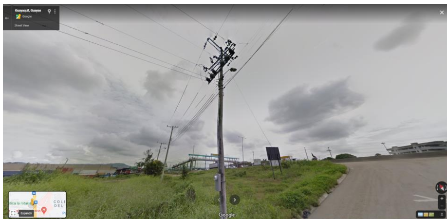
Figura 3.3. Poste donde se realizará el punto de interconexión. Fuente: Google Earth
