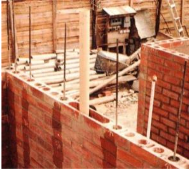
Ilustración 7. Instalación de tuberías para servicios dentro de bloques de mampostería reforzada. Adaptado de Mampostería Reforzada de Dóri Sirály (2016).
