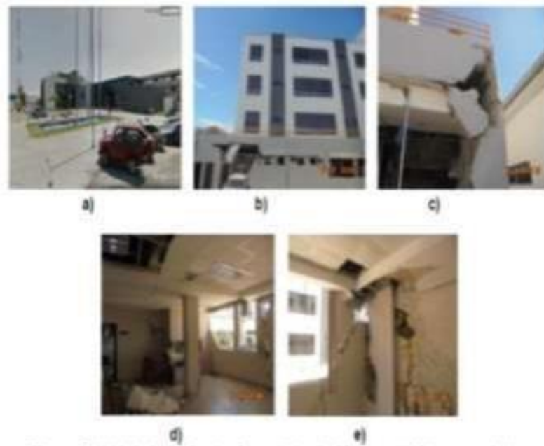
Ilustración 26 UVC de Manta, a) Vista general, b) Mampostería con daño extensivo en fachada principal de ingreso, c) Mampostería con daño extensivo en fachada posterior, d) Columnas de acero rellenas de hormigón, e) Falta de elementos confinantes. Fuente: Aguiar, 2016
