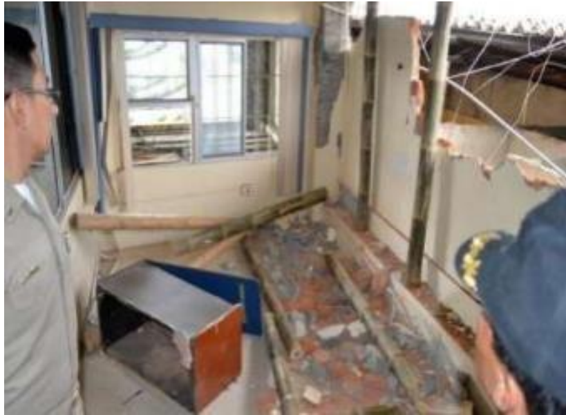
Ilustración 24 Reconocimiento de daños en Capitanía del Puerto de Manta. Fuente: Diario Expreso, 2016
