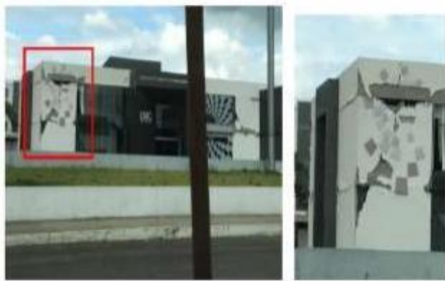
Ilustración 17 Daños en UVC de Portoviejo después del sismo del 16 de abril de 2016. Fuente: GEER - ATC, 2016
