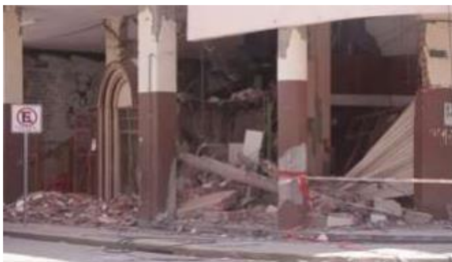
Ilustración 19 Daños presentados en edificio, formación de rótulas plásticas. Fuente: Ing. Alex Villacrés, 2016
