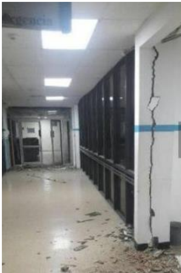
Ilustración 30 Daños en el interior del Hospital Naval a causa del sismo. Fuente: Diario El Universo, 2016
