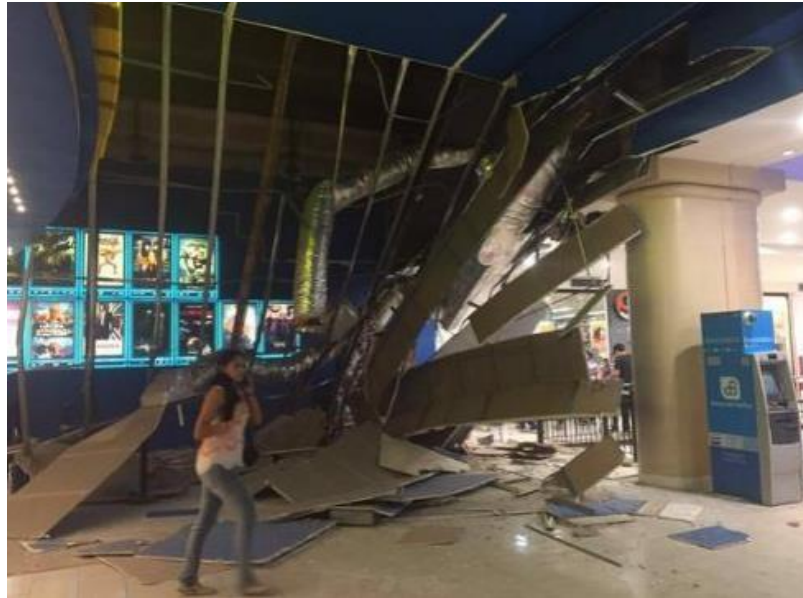
Ilustración 34 Tumbado colapsado cerca de Supercines debido al sismo
