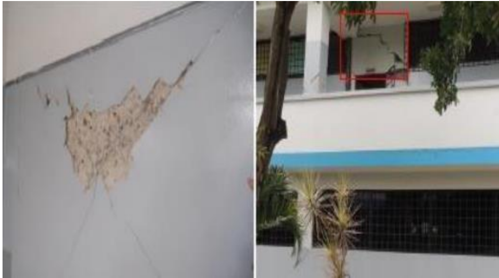
Ilustración 16 Daños localizados de la U. E. Cristo Rey. Fuente: GEER - ATC, 2016
