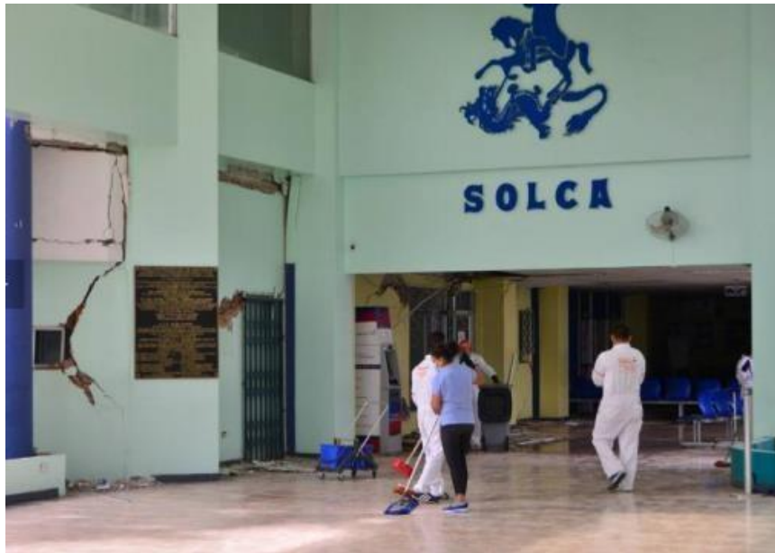
Ilustración 28 Daños en instalaciones de Solca debido al sismo del 16 de abril de 2016
