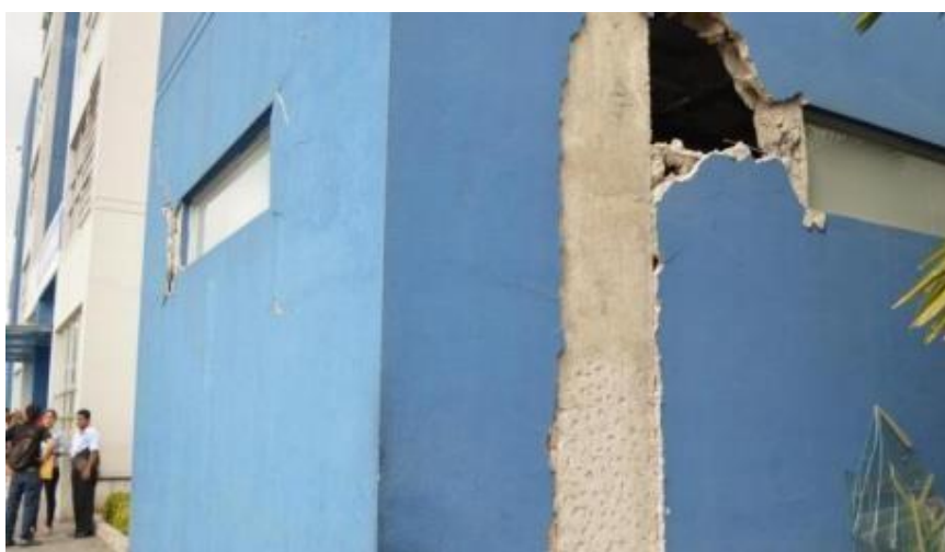
Ilustración 27 Daños en el edificio Unidad de Flagrancia por el sismo del 16 a
