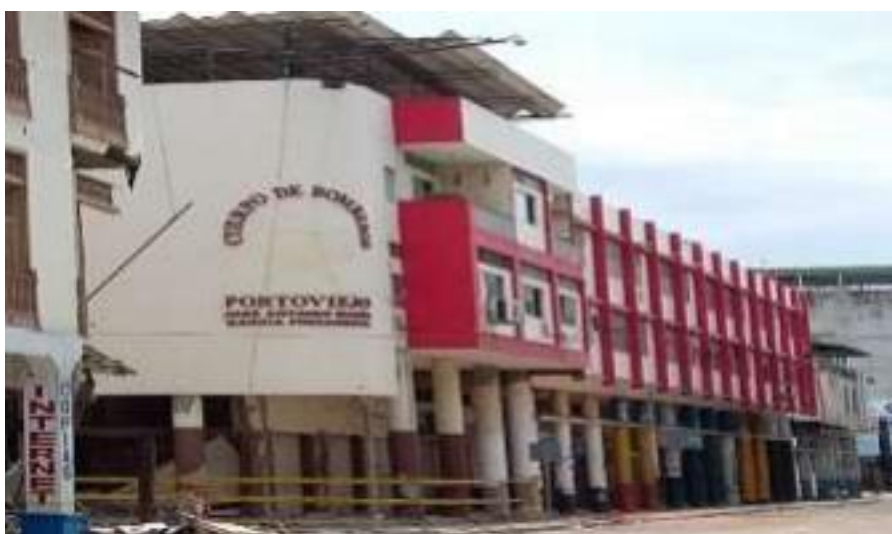
Ilustración 18 Cuartel de Cuerpo de Bomberos después del sismo del 16 de abril de 2016. Fuente: Ing. Alex Villacrés, 2016
