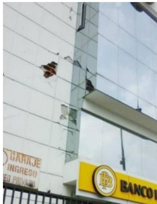
Ilustración 37 Daños ocasionados por el sismo en el banco
