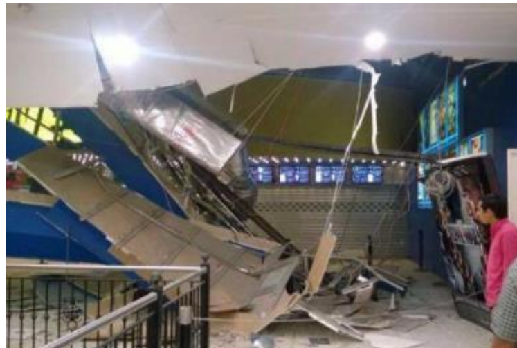
Ilustración 35 Vista frontal del colapso del tumbado
