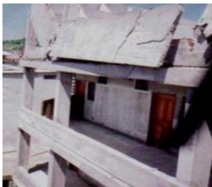
Ilustración 15: Edificio Extensión Universidad Eloy Alfaro luego del terremoto de 1998
