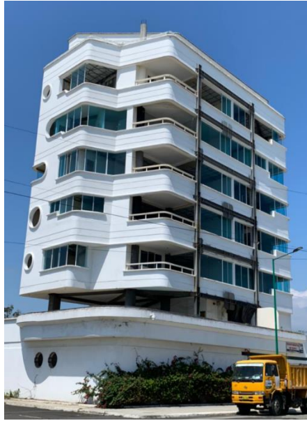
Ilustración 43: Vista lateral del Edificio Agua Marina, está siendo reforzado después del terremoto del 16 de abril del 2016.
