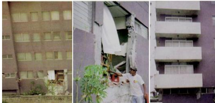
Ilustración 31: Edificio Los Corales luego del terremoto de 1998
