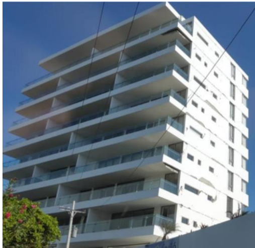
Ilustración 53: Daños en mampostería en el Edificio Cariló después del terremoto del 16 de abril del 2016.
