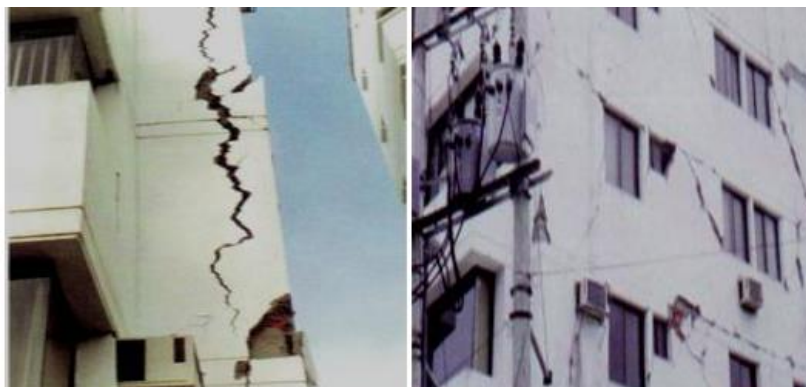
Ilustración 34: Edificio Spondylus luego del terremoto de 1998
