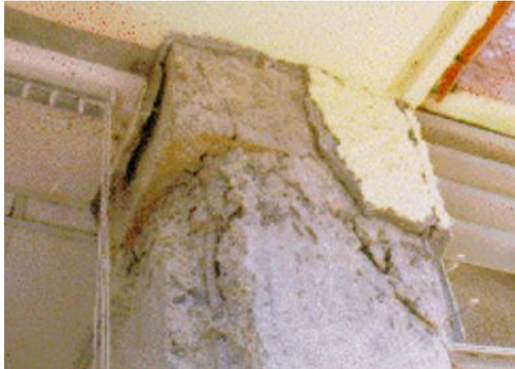
Ilustración 36: Hospital Miguel H. Alcívar, mala práctica en la fundición de las columnas, después del terremoto del 4 de agosto de 1998.
