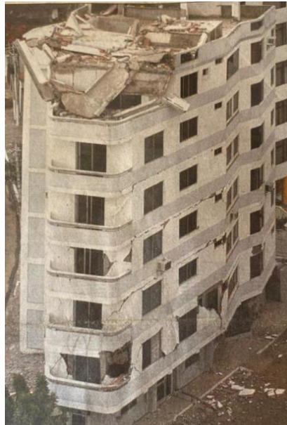
Ilustración 16: Edificio Marun Jalil luego del terremoto de 1998
