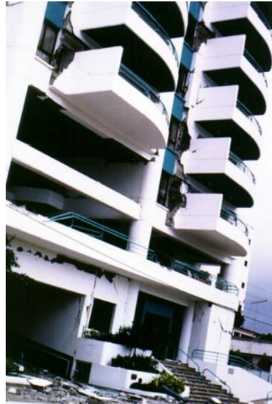
Ilustración 13: Edificio Cabo Coral luego del sismo de 1998
