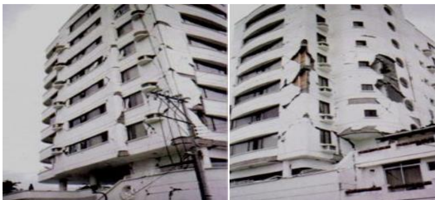
Ilustración 24: Edificio Salango luego del terremoto de 1998
