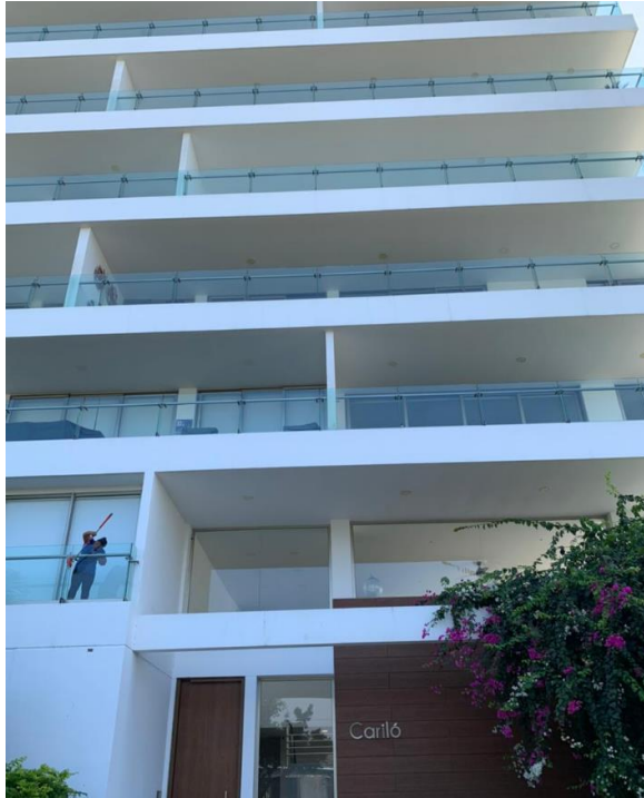
Ilustración 57: Vista frontal del Edificio Cariló después del terremoto del 16 de abril del 2016.
