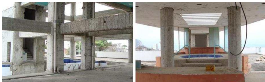
Ilustración 10: Concentración de masas en el edificio Cabo Coral. A la derecha jacuzzi en octava planta, a la izquierda piscina en la segunda planta
