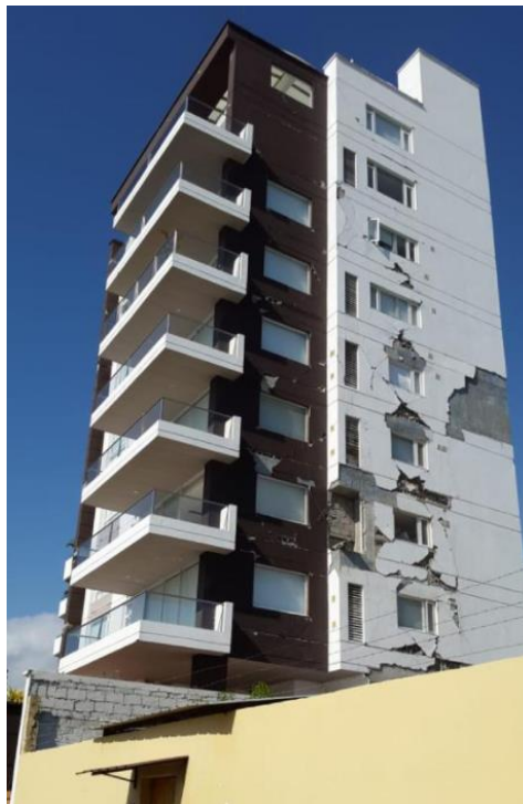
Ilustración 47: Daños en mampostería en el Edificio Akuaba después del terremoto del 16 de abril del 2016.
