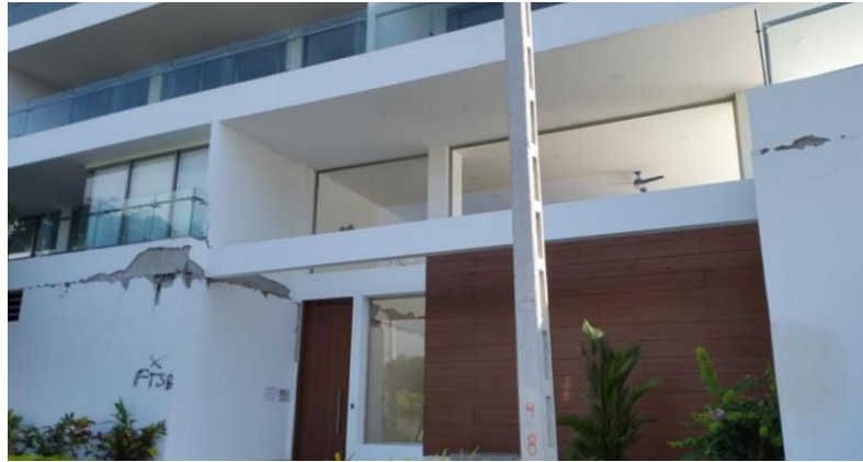
Ilustración 55: Entrada principal antes de la reparación del Edificio Cariló.
