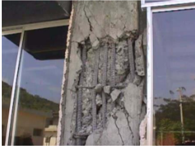
Ilustración 38: Hospital Miguel H. Alcívar, fallo en columnas perimetrales de planta baja, después del terremoto del 4 de agosto de 1998.
