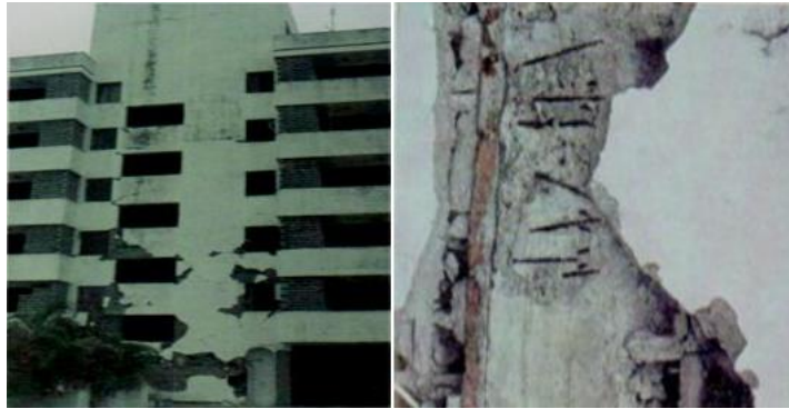
Ilustración 20: Edificio Neptuno luego del terremoto de 1998
