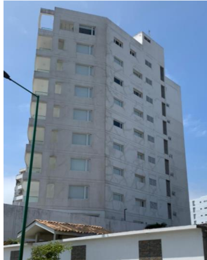
Ilustración 60: Vista posterior del Edificio El Faro, reparado después del terremoto del 16 de abril del 2016.
