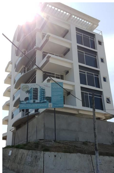
Ilustración 65: Edificio Bahía de Caráquez luego del terremoto del 2016.
