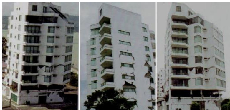
Ilustración 25: Edificio Nautilus luego del terremoto de 1998
