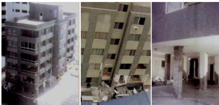
Ilustración 18: Edificio El Delfín luego del terremoto de 1998
