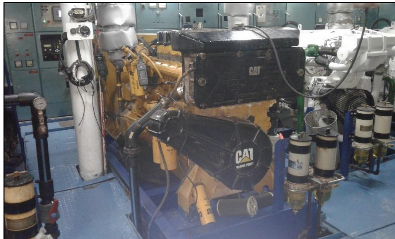
Figura 3.4: Grupo generador de 600 kW instalado en bases de metal.
