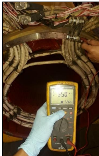
Figura 3.9: Registro del nivel de aislamiento en las bobinas del estator principal Elaborado por: Autor
