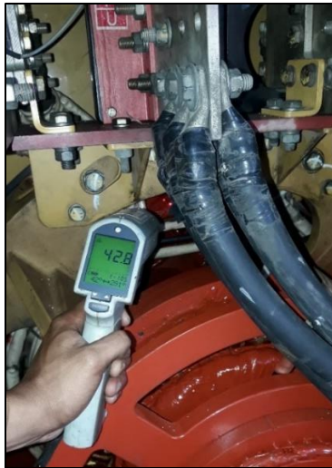
Figura 3.8: Medición de la temperatura del bobinado del estator principal Elaborado por: Autor
