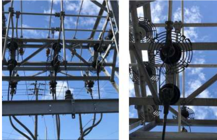
Figura 2-33: Dispositivos electrostáticos colocados sobre los aisladores de porcelana de los soportes de las cuchillas en una subestación
