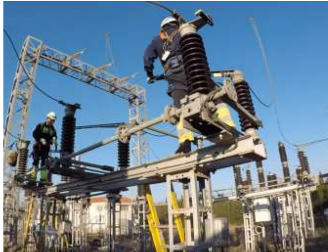
Figura 2-9: Mantenimiento de apartarrayos en una subestación eléctrica Fuente: (Instalaciones y Proyectos de Vanguardia, 2017)
