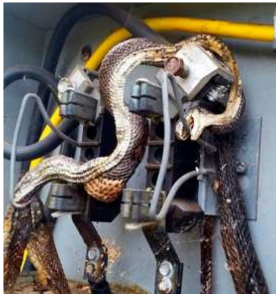
Figura 2-27: Réptil dentro de un tablero eléctrico afectando el cableado Fuente: (Tecsa, 2020)
