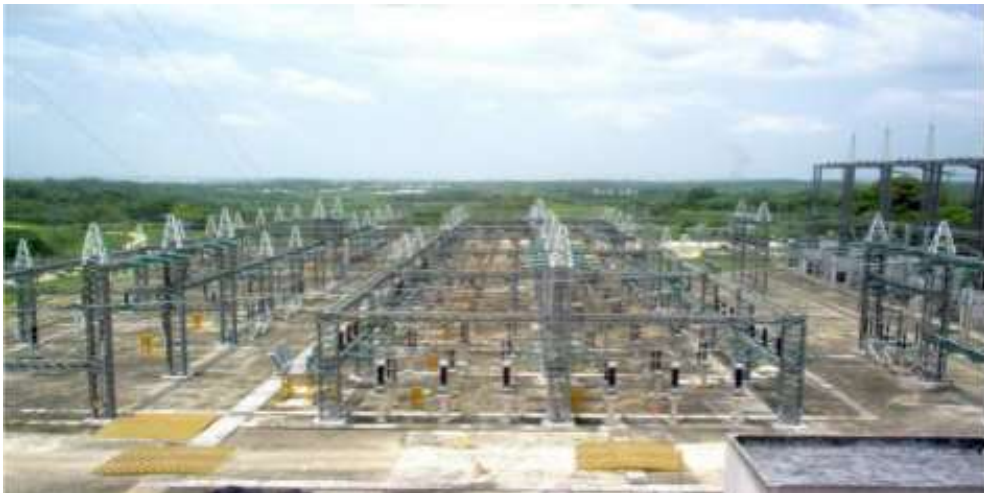
Figura 2-12: Subestación eléctrica de maniobra Fuente: (Instituto tecnológico de Los Mochis, 2017)
