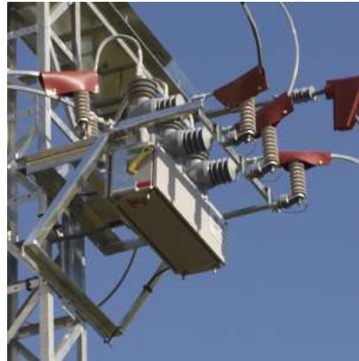
Figura 2-5: Restaurador trifásico smART RC Fuente: (Arteche, 2021)
