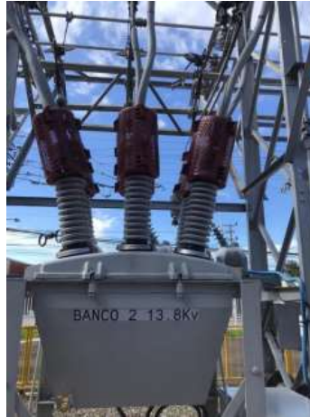
Figura 2-35: Protectores rígidos colocados en aisladores de porcelana de interruptores de una subestación Fuente: (CNFL, 2020)
