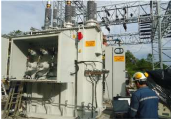
Figura 2-11: Prueba de protecciones del sistema de potencia eléctrica
