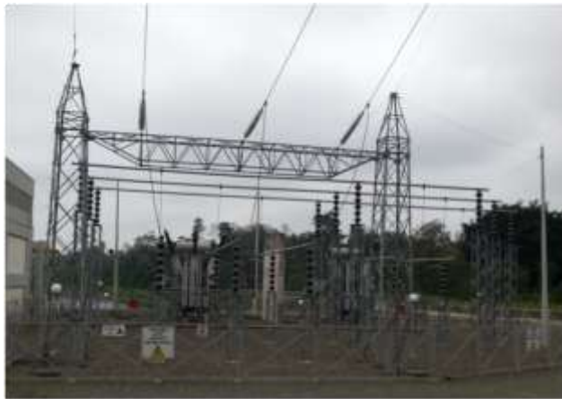
Figura 2-13: Subestación eléctrica elevadora Baba Fuente: CELEC, 2014
