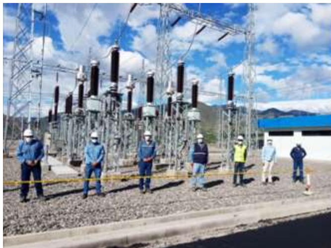
Figura 2-17: Subestación tipo intemperie
