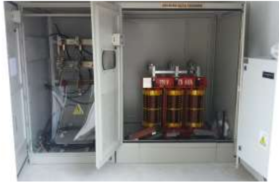
Figura 2-18: Subestación tipo interior Fuente: ISM Ingeniería, 2020
