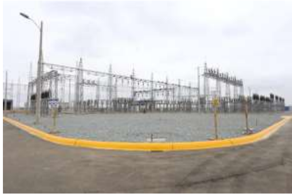
Figura 2-2.: Subestación eléctrica de Durán, Provincia Guayas Fuente: (Naranjo, 2021)
