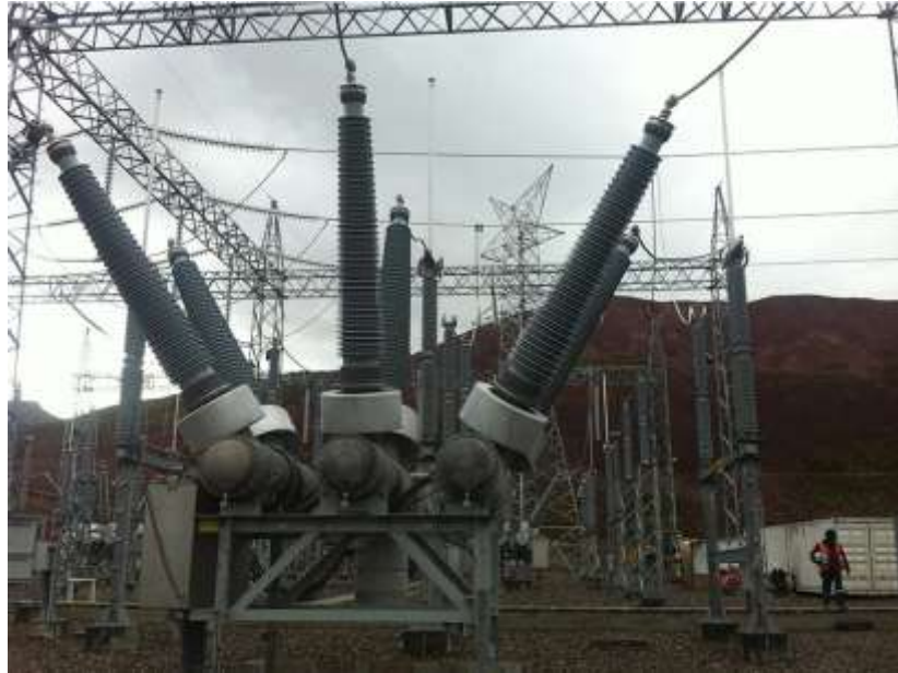
Figura 2-4: Interruptor de potencia Fuente: (Ingelmec, 2017)
