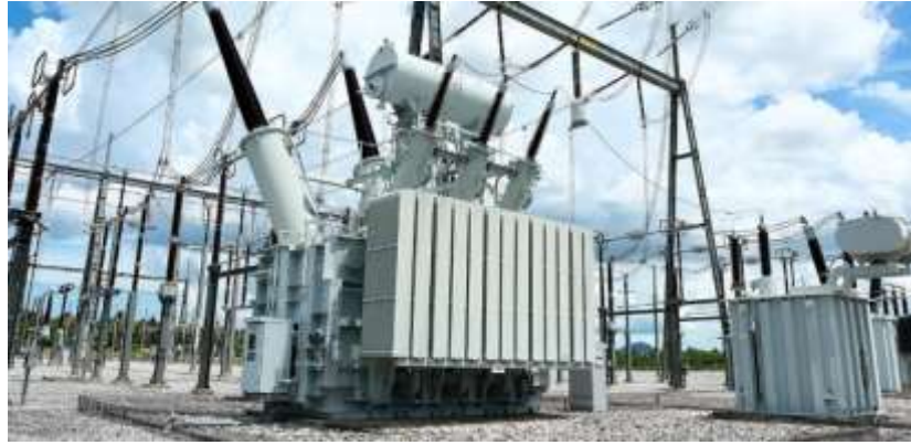
Figura 2-3: Transformador eléctrico Fuente: (Endesa, 2021)
