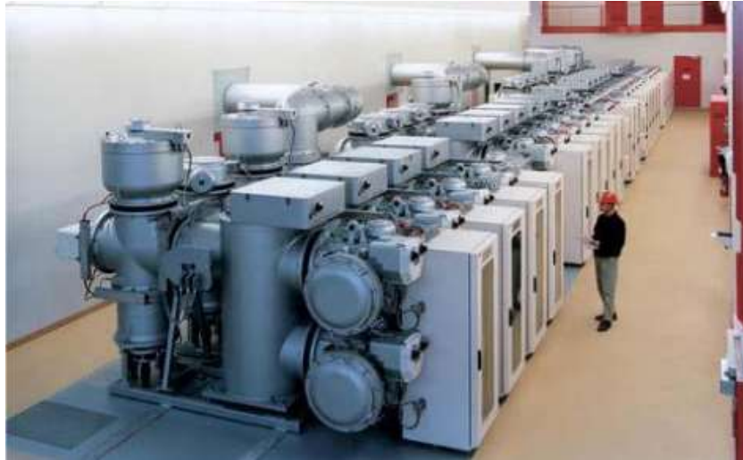
Figura 2-19: Subestación de tipo blindada Fuente: (RAPE, 2020)
