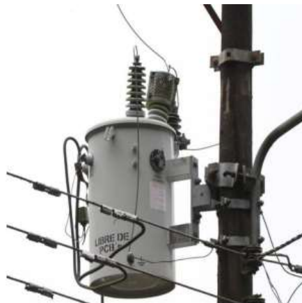
Figura 2-36: protectores de polímero rígido para protección del terminal de un transformador
