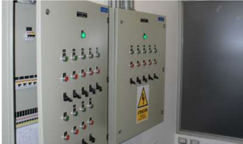
Figura 2-7: Tablero eléctrico Fuente: (Grupo Diganma, 2021)
