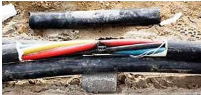
Figura 2-21: Fallo en el aislamiento de un cable subterráneo producido por la humedad Fuente: (TECSA, 2020)
