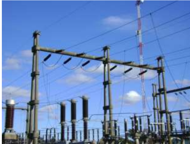
Figura 2-10: Barras colectoras en 132 kV en una subestación eléctrica Fuente: (Sector Electricidad, 2020)
