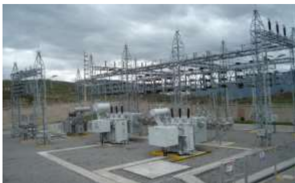
Figura 2-14: Subestación reductora Alpacacha Fuente: CELEC, 2018
