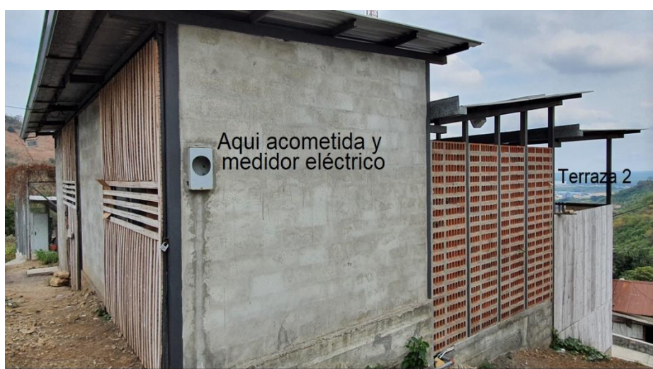
Figura 4. 1 Ubicación del medidor para acometida eléctrica
