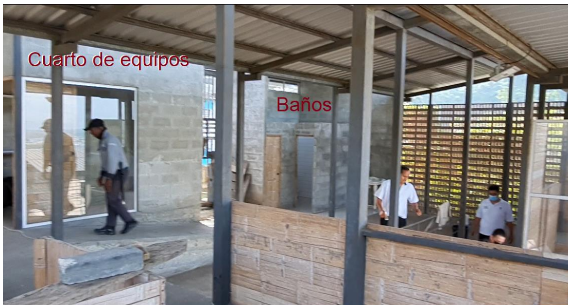
Figura 3. 6 Área principal con su cuarto de equipos
