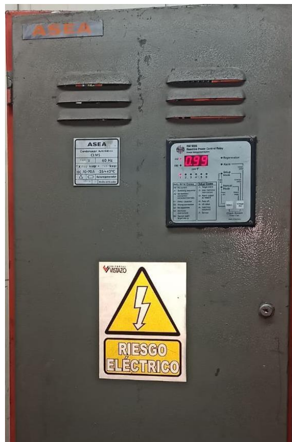
Figura 3.27. Tablero de condensadores 220V. Fuente: (ENSA,2022)
