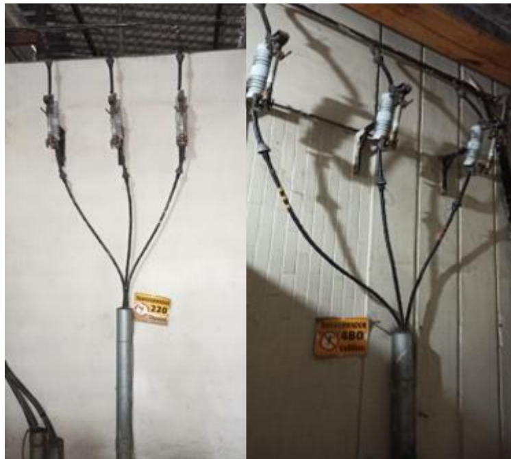
Figura 3.13. Porta fusibles para líneas de transformador de 220V y 480V. Fuente:(ENSA,2022)
