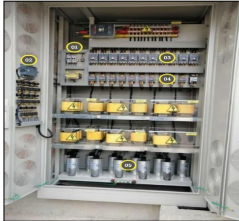
Figura 2.16. Banco de capacitores. Fuente: (Hidalgo, 2017)
