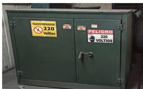
Figura 3.16. Transformador 220 V. Fuente:(ENSA,2022)
