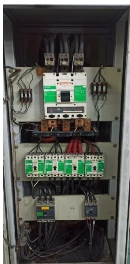
Figura 3.23. Tablero de distribución 480 V. Fuente: (ENSA,2022)
