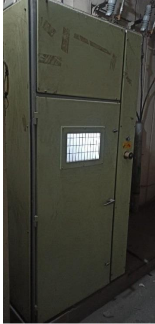
Figura 3.12. Celda de media tensión Fuente:(ENSA,2022)
