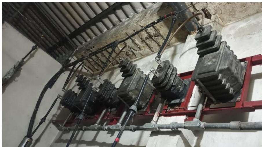
Figura 3.11. Transformadores de potencial y transformadores de corriente Fuente:(ENSA,2022)
