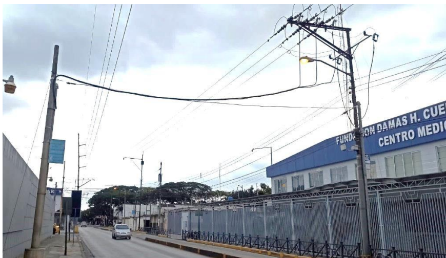
Figura 3.10. Acometida eléctrica Fuente:(ENSA,2022)
