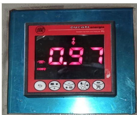
Figura 3.26. Controlador automático en servicio. Fuente: (ENSA,2022)
