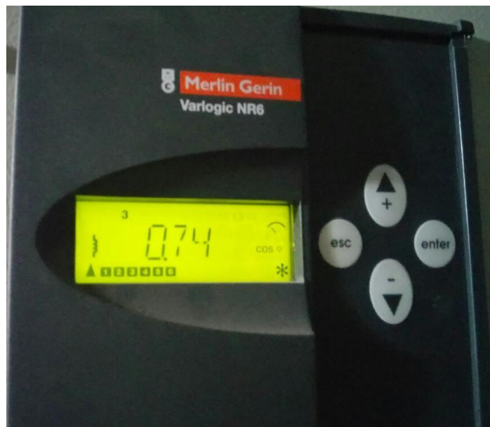
Figura 3.20. Controlador de factor de potencia con mediciones erróneas. Fuente: (ENSA,2022)
