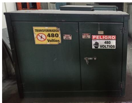
Figura 3.15. Transformador 480V. Fuente:(ENSA,2022)
