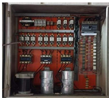
Figura 3.24. Tablero de condensadores 480 V. Fuente: (ENSA,2022)
