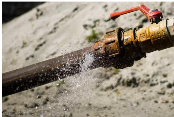
Ilustración: Fuga en tubería subterránea. Fuente: (HIDROTEC, s.f.)
