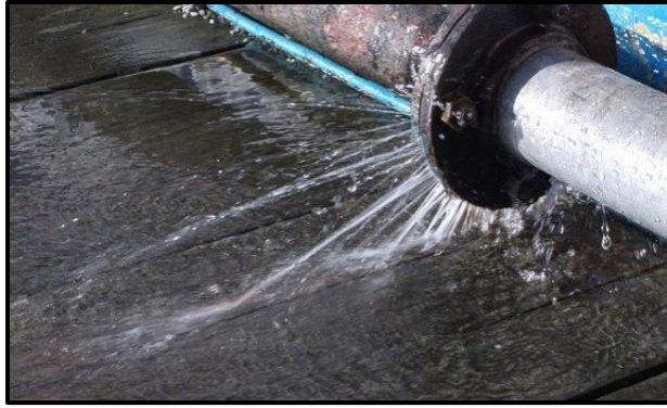
Ilustración 5: Fuga en unión de tuberías. Fuente: (MORKENGROUP, s.f.)
