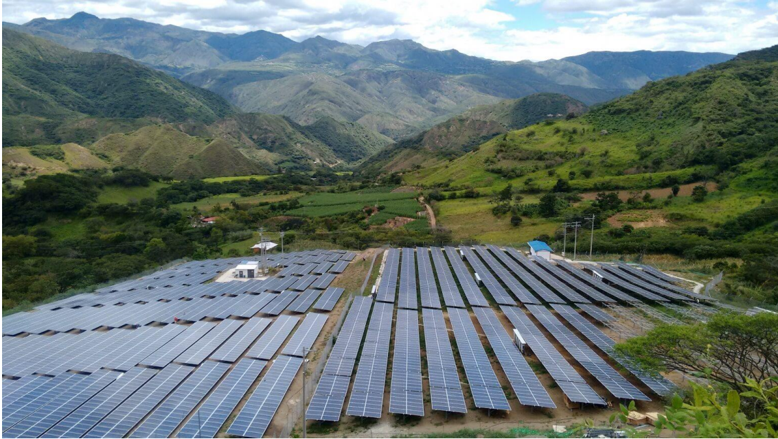
Ilustración 37. Parque solar fotovoltaico Loja Energy. Loja, Ecuador. Fuente: Solartia
