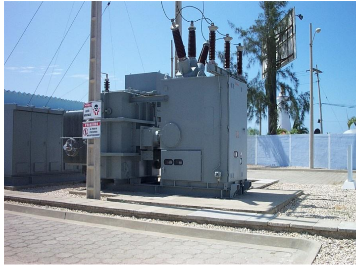
Figura 20 Transformador de alta tensión ( 5 MVA)
