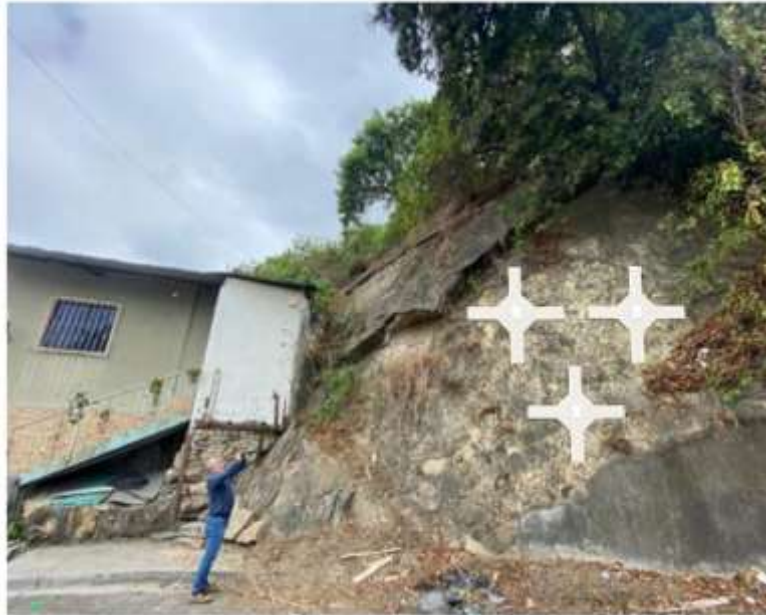
Figura 83. Tres crucetas instaladas al pie del talud en zona expuesta (zona cerro San Eduardo-Monumental)
