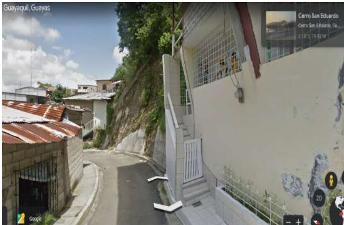
Figura 50. Altas pendientes de los taludes del cerro San Eduardo
