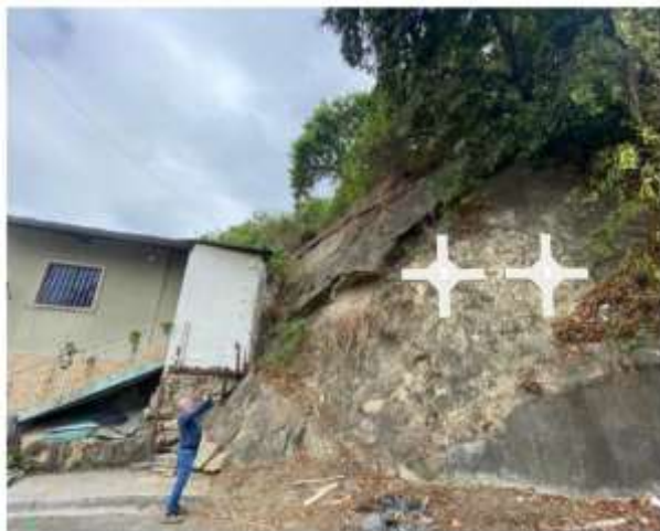
Figura 82. Dos crucetas instaladas al pie del talud en zona expuesta (zona cerro San Eduardo-Monumental)
