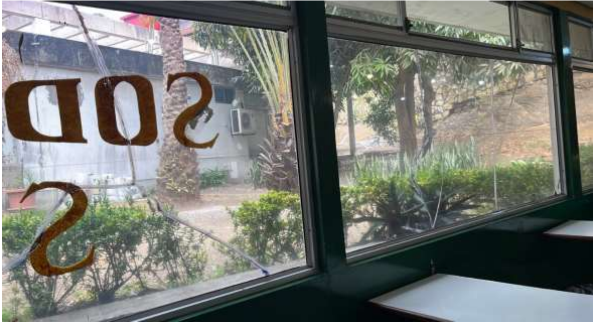
Figura 55 Daño en las ventanas del bar. Fuente: Propio.
