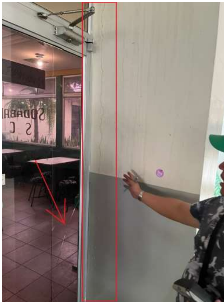
Figura 54 Daño en la columna por el golpeteo entre la Facultad de Ingeniería y el bar de Colón. Fuente: Propio.
