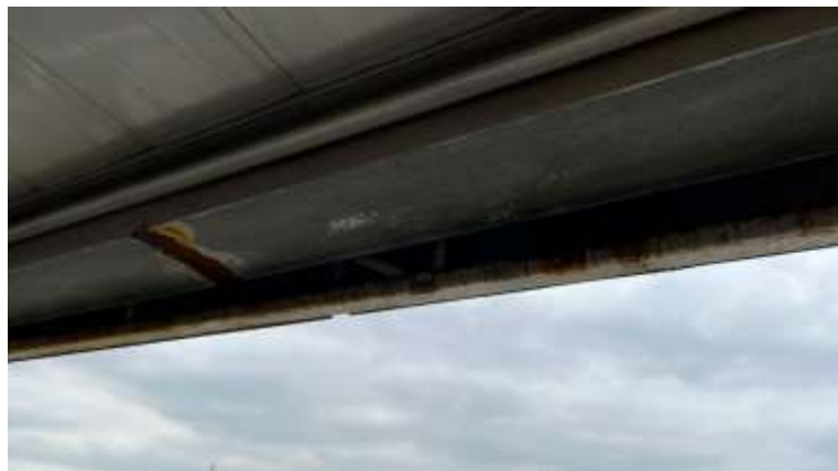
Figura 12 Parte corroída de la estructura metálica. Fuente: Propio, foto tomada el 31/10/2022
