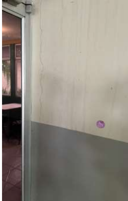
Figura 22 Columna Colón con grieta visible. Fuente: Propio.
