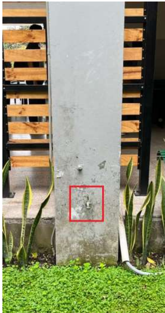
Figura 24 Columna de Colón donde se puede ver un grifo. Fuente: Propio.
