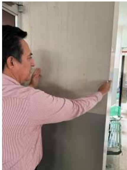
Figura 23 Ingeniero Julio Vargas dando los resultados de la lectura del Profoscope. Fuente: Propio.
