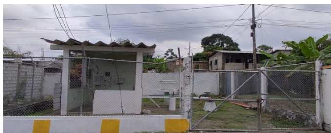
Figura 16 Sitio donde se encuentra el sistema de la bomba de distribución de agua.
