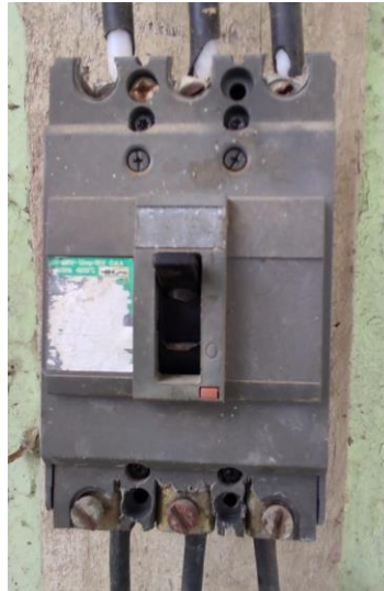
Figura 20 Disyuntor principal de 100A.
