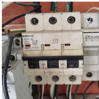
Figura 21 Disyuntor principal de 63A.
