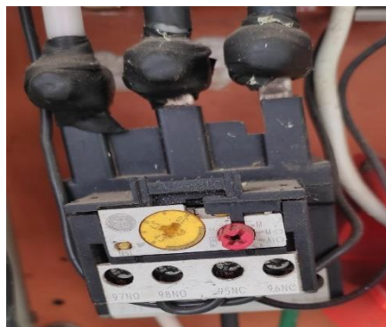
Figura 23 Relé térmico del circuito de control.
