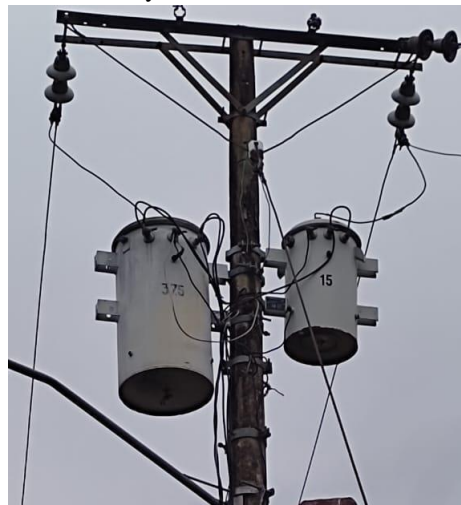
Figura 18 Transformadores monofásicos convencionales de capacidad de 37.5kVA y 15 kVA
