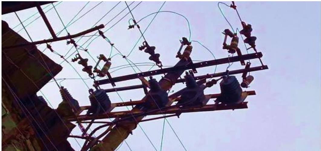
Fuente: (Tendales Nestlé, 2022). Transformador de corriente y voltaje. Fotografías tomadas por la misma autora.
