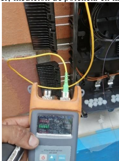
Figura 2.17: Power Meter, medición de potencia en la caja de distribución NAP
