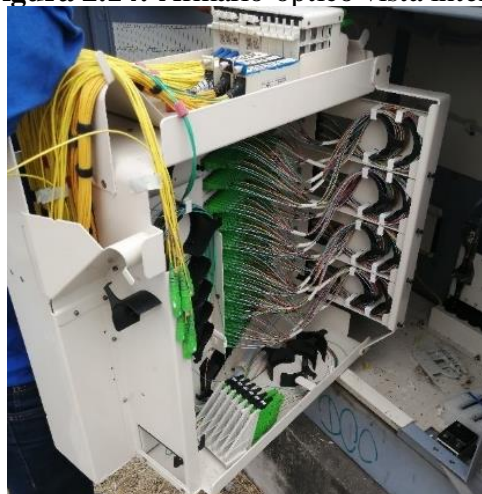
Figura 2.14: Armario óptico vista interna
