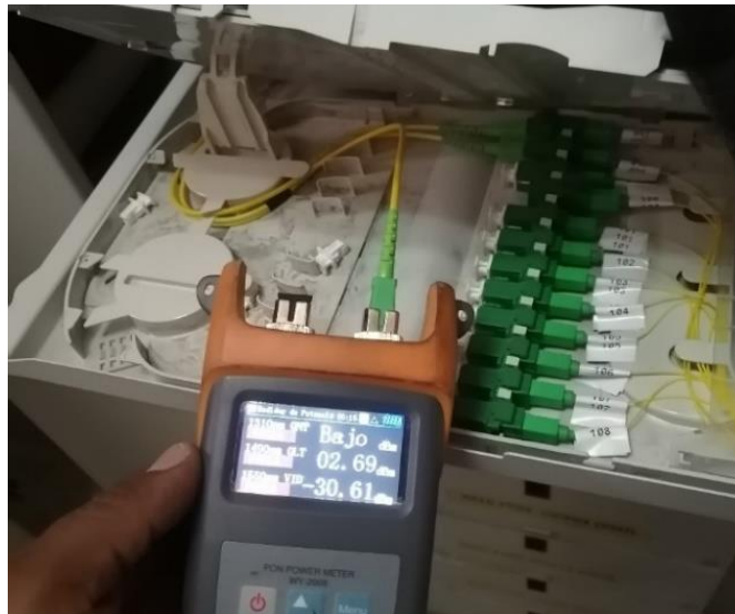
Figura 3.5: Mediciones ópticas en las salidas de los puertos de la OLT
