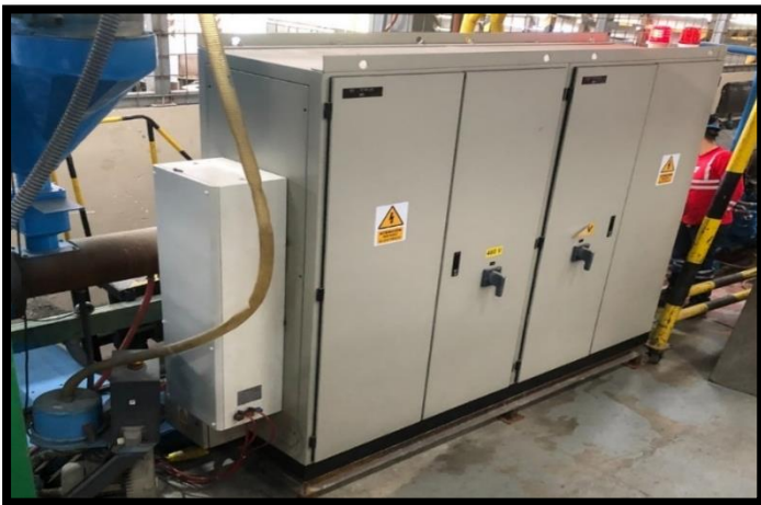
Figura 3. 7. Tablero de distribución. Fuente: Los autores.
