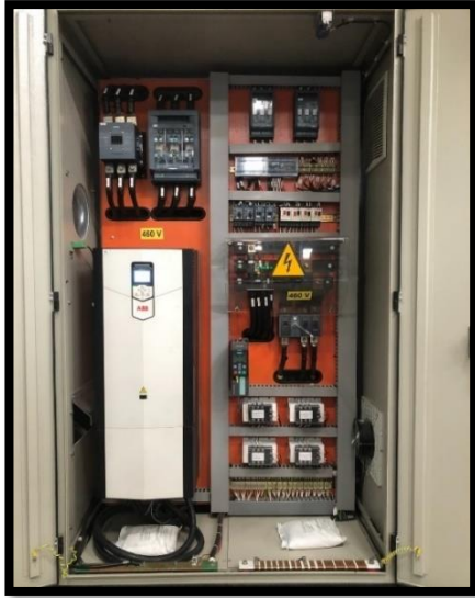
Figura 3. 8. Tablero de 460 V CA. Fuente: Los autores.
