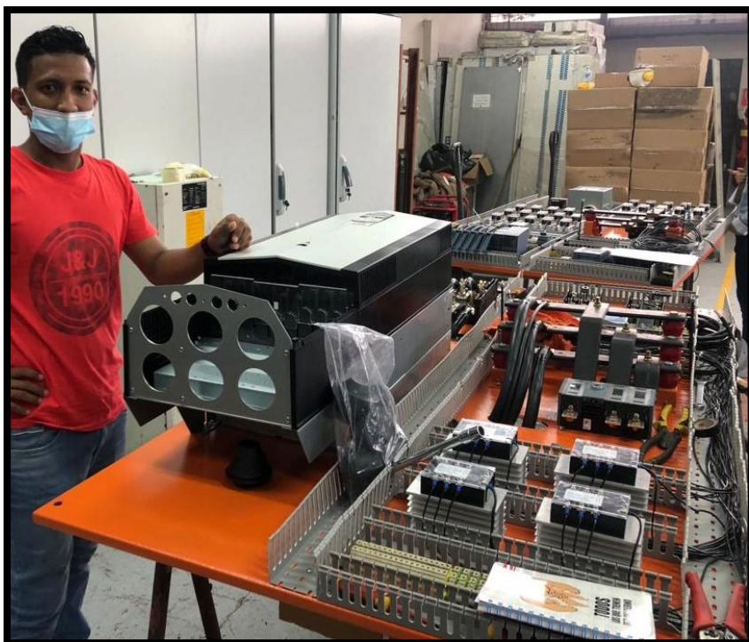
Figura Anexo 2. 3. Cableado del tablero para el sistema de fuerza en conjunto con el supervisor de la subárea de extrusión.
