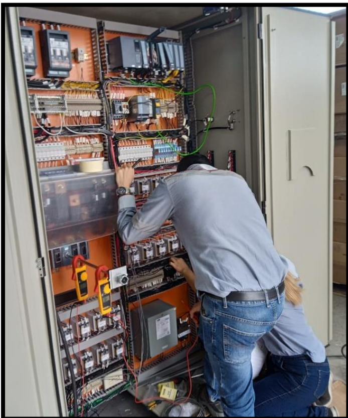
Figura Anexo 2. 2. Cableado del tablero para el sistema de control. Fuente: Los autores.
