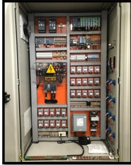
Figura 3. 9. Tablero de 380 V CA. Fuente: Los autores.
