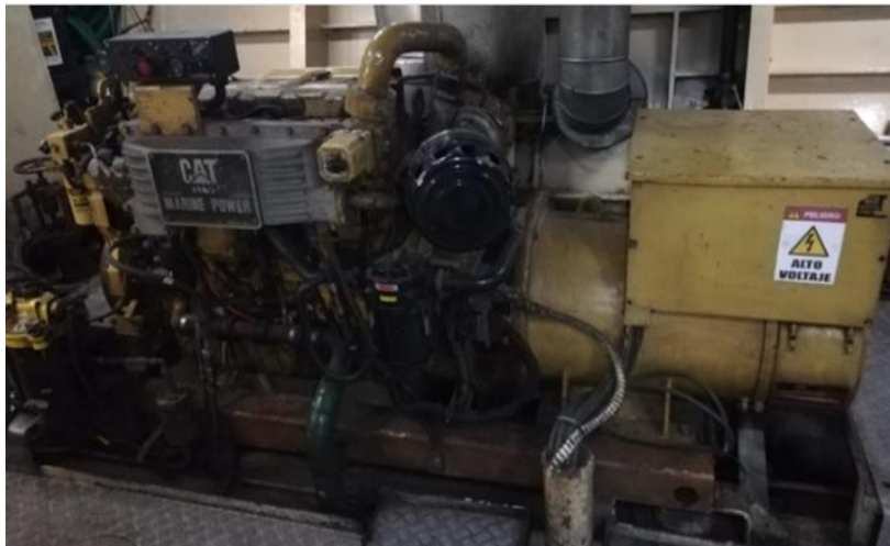
Figura 2.4: Generador con motor diésel CAT C9
