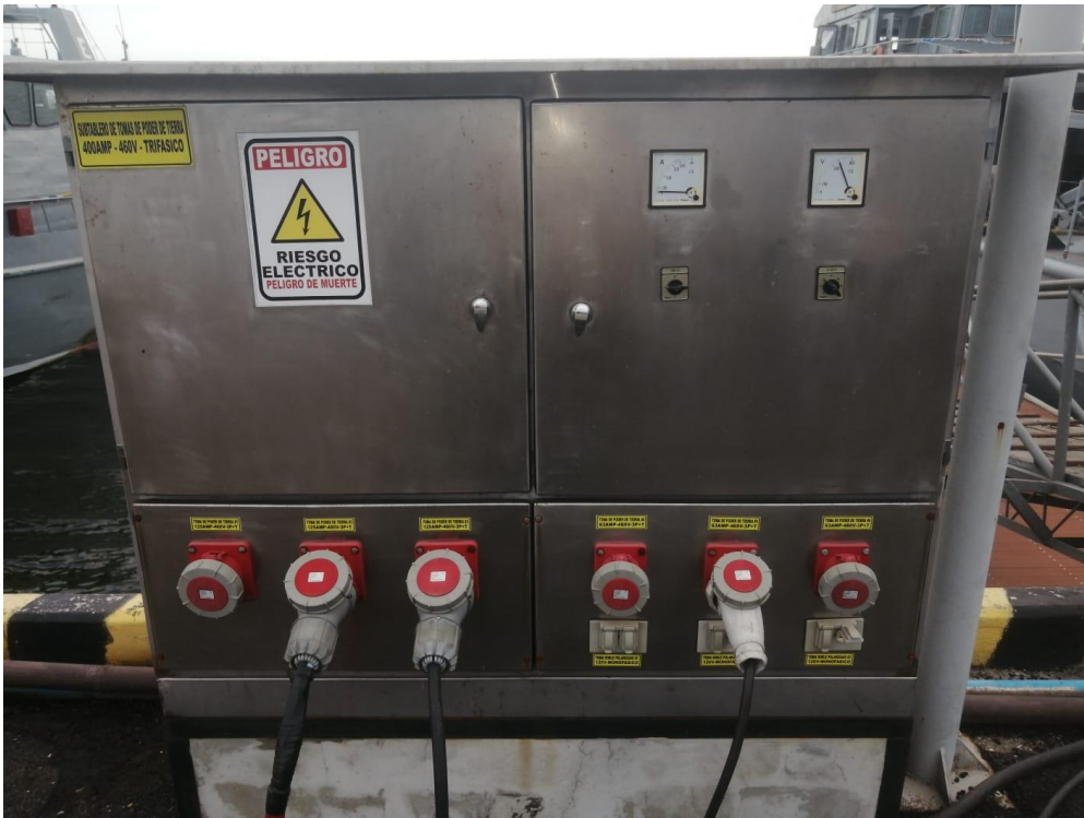
Figura A7: Tablero eléctrico del Muelle COGUAR
