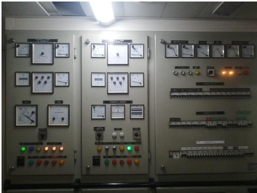
Figura A2: Tableros eléctricos principales
