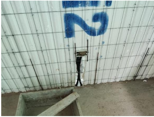
Figura 33 Punto tomacorriente en Ciudad Santiago Etapa V. Fuente: Autor, 2023
