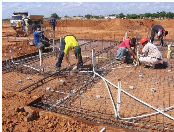
Figura 23 Acero estructural con instalaciones en cimentación. (Arévalo Serrate, Rubio Gámez, & Ondia Alonso, 2013))
