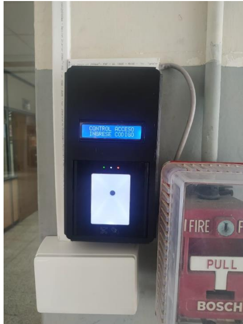
Figura 44 - Dispositivo de lectura instalado
