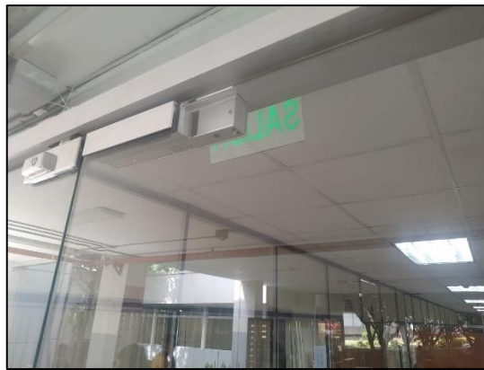
Figura 42 - Cerradura electromagnética instalada
