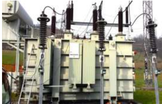
Figura 14. Transformador de potencia
