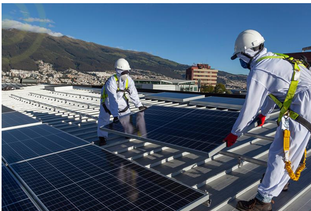
Figura 6: Modulo – panel fotovoltaico
