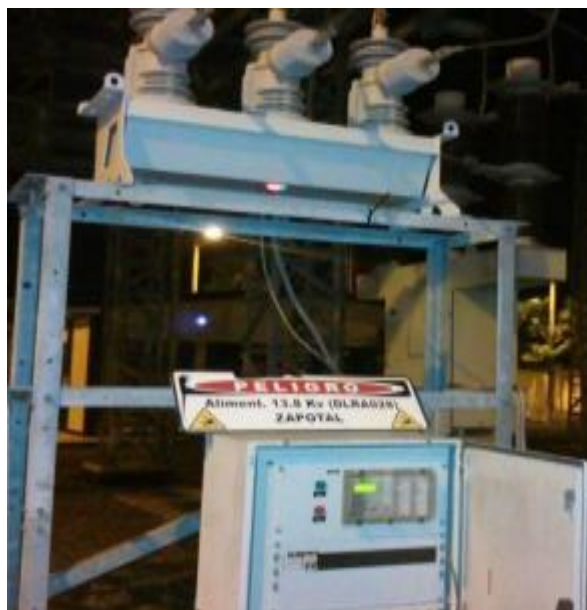
Figura 3.2: Reconector del Alimentador de Zapotal de Ventanas.
