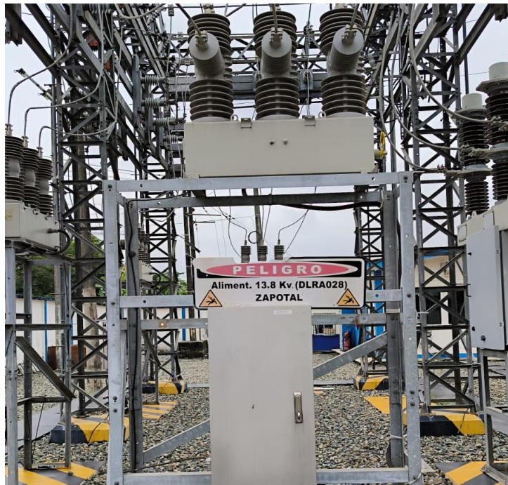
Figura A3: Reconector eléctrico de 13.8 kv de Zapotal
