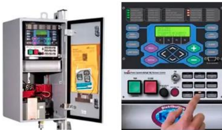
Figura 2.7: Gabinete de control y controlador de reconectador eléctrico.
