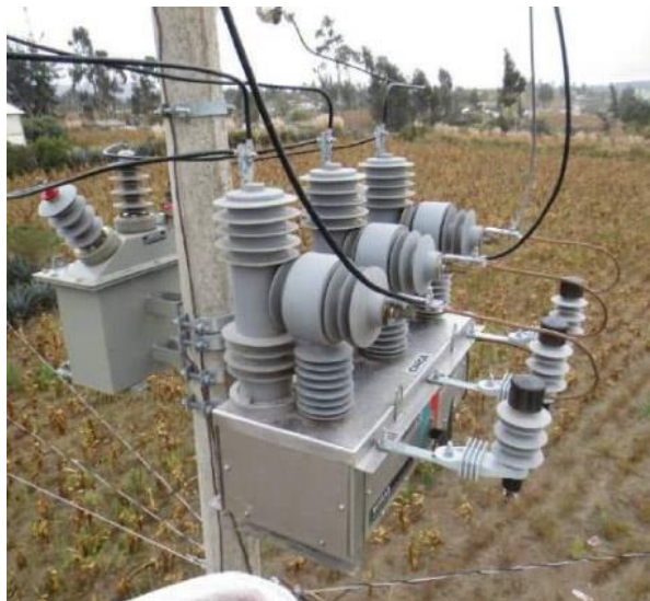
Figura 2.9: Reconector eléctrico de poste.
