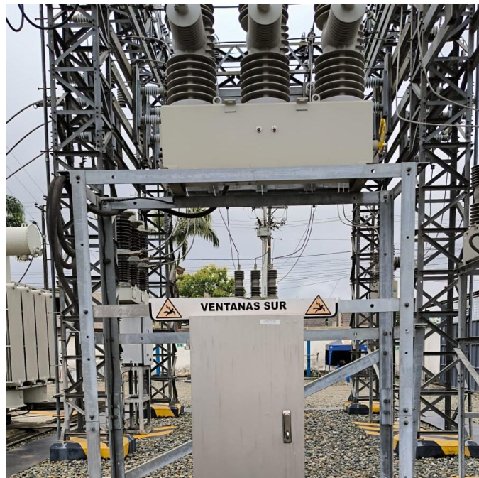
Figura A7: Reconectador eléctrico de 13.8 kv de Ventanas Sur
