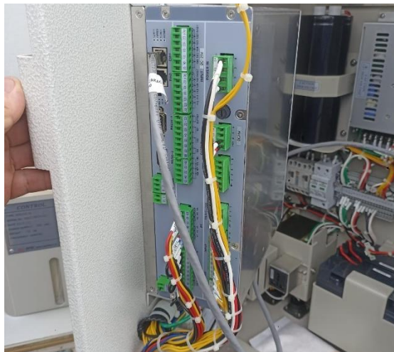
Figura 3.10: Conectores del tablero de control del Reconectador
