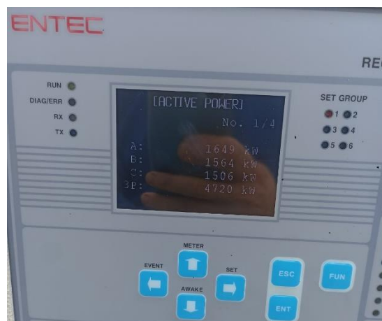
Figura 3.18: Datos de potencia activa del control digital ETR300-R
