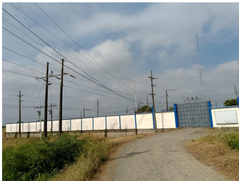
Figura A3: Exteriores de la entrada de la subestación eléctrica
