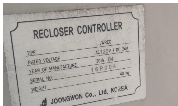
Figura 3.5: Placa técnica de los datos del Reconector de transferencia
