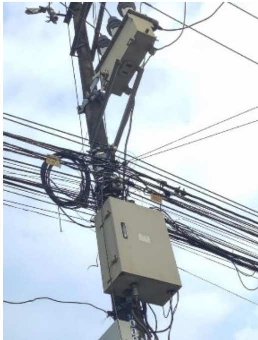
Figura 3.3: Reconector de transferencia del Alimentador Caracol
