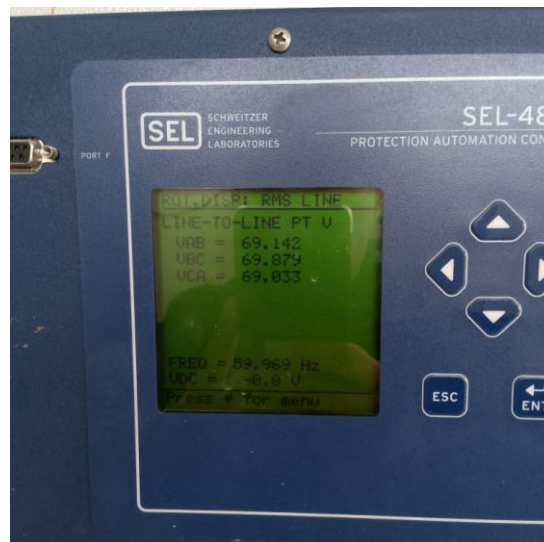
Figura 3.8: Medidor Sel-487 B para voltajes, corriente y fallas de 96KVA
