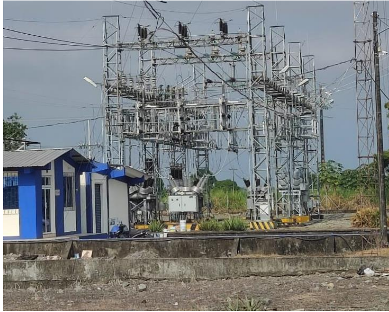
Figura A4: Redes eléctricas de alta tensión de la subestación
