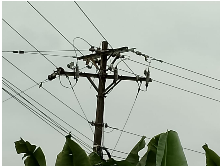
Figura A11: Seccionamiento Rosita
