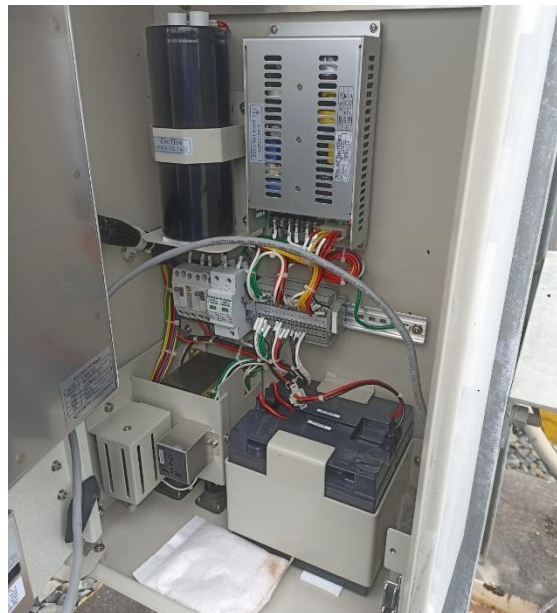
Figura 3.9: Parte interna del tablero de control del Reconector
