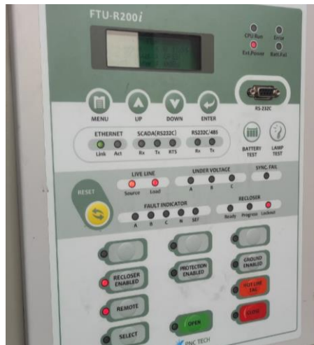
Figura 3.4: Tablero de control de Reconector de transferencia
