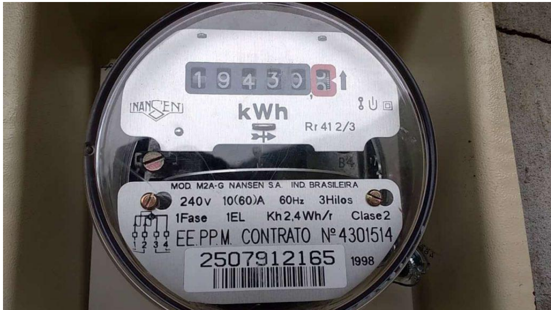
Figura 2. Medidor del consumo de energía eléctrica
