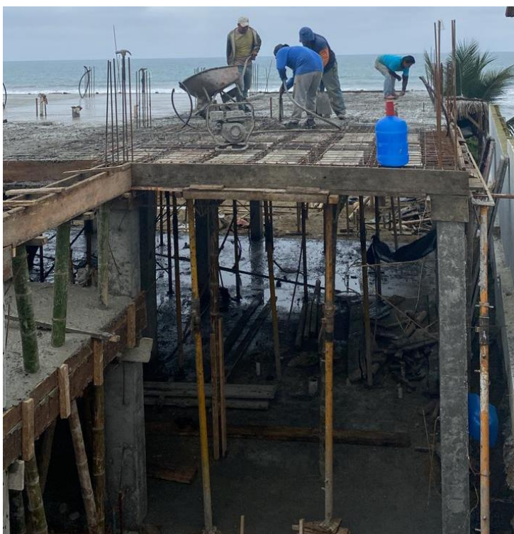
Fig- 25 Espacios reducidos por fundición de losa.
