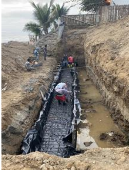
Fig- 27 Acero del muro cercano al mar. (Fuente Propia,2024)
