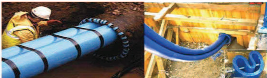
Imagen 17. Tubería deformada en “U”
