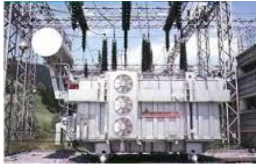
Fig. 2.11 Transformador de distribución
