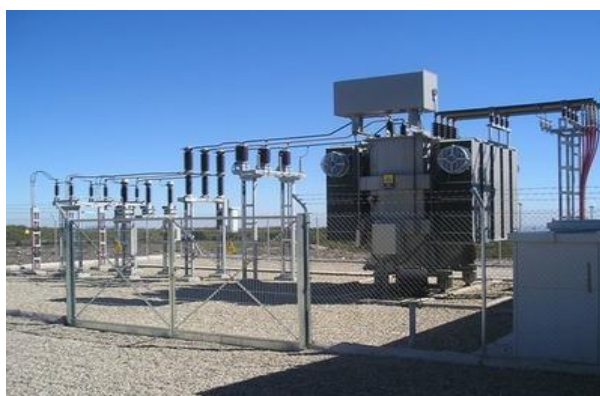
fig. 2.9 Subestaciones compactas y/o abiertas
