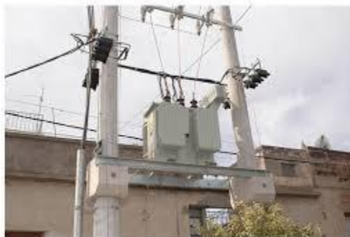
Fig. 2.15 Transformadores para línea de baja tensión
