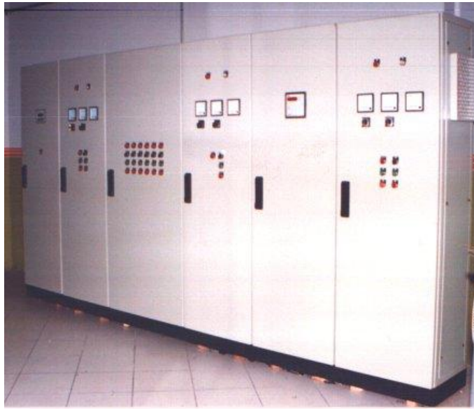
Fig. 2.13 Tableros de distribución general
